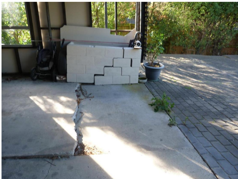
Figura 20 Fissuras no betão causadas por um deslocamento permanente das encostas, desencadeado pelo terramoto de 2011 em Christchurch [35].
