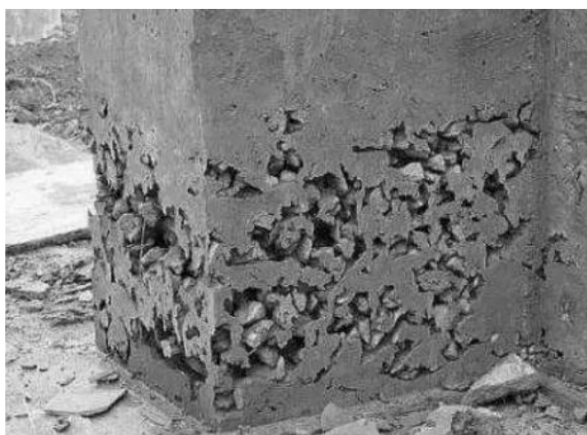
Figura 37 Segregação do betão causada por uma mistura irregular [67].
