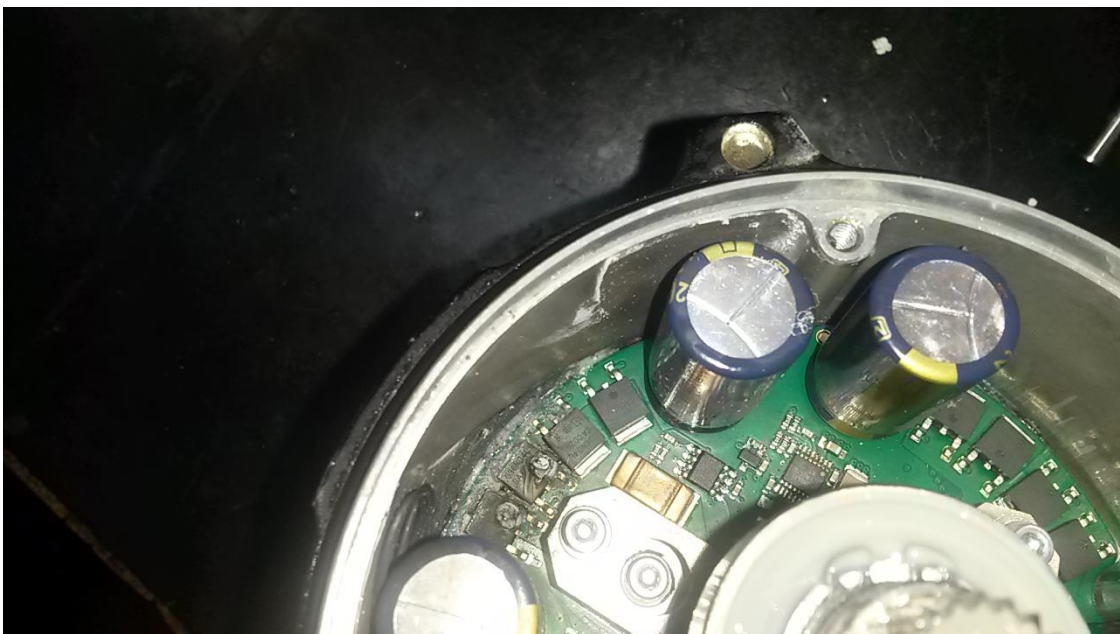
Figura 49 - Componentes danificados na placa de comando do motor elétrico
