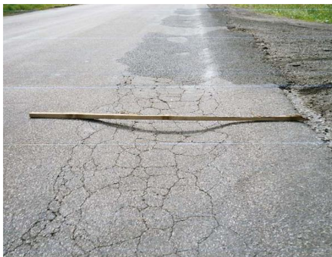
Figura 5.6. Rutura e fissuração de um pavimento degradado com má drenagem (adaptado de Dawson, 2007)
