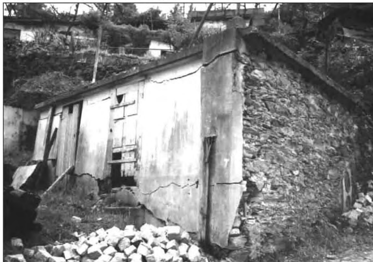
Figura 7 – Efeitos da subsidência mineira em habitações e muro suporte na área de Germunde (Perfil S). Confrontar com os esquemas da Figura 1 (Fotografias: Helder I. Chaminé, abril de 1991). In: Chaminé (1992).
