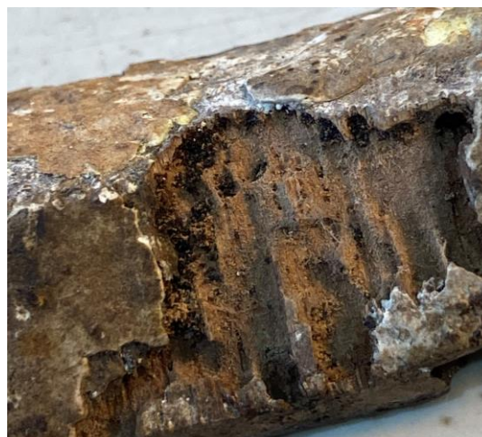
Figura 76- Galerias provocadas por insetos xilófagos. (A.P.)
