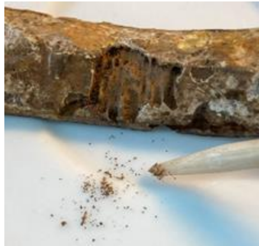
Figura 78- Remoção do pó de madeira localizados nas galerias causadas por insetos xilófagos. (A.P.)
