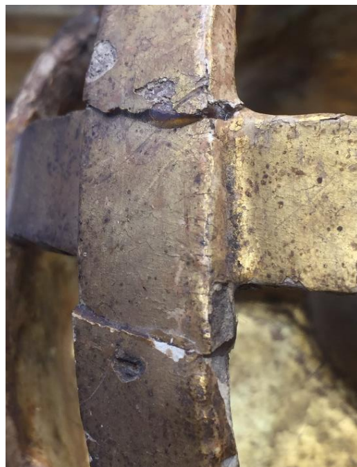
Figura 177- Fraturas da estrutura em madeira. (A.P.)
