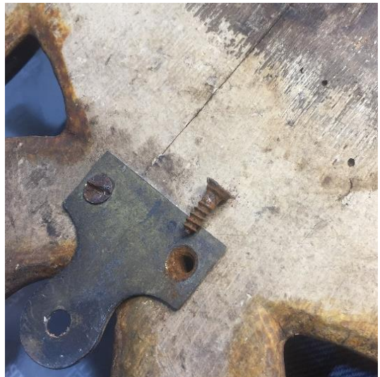
Figura 60- Pormenor do estado de conservação dos acessórios metálicos fixados com parafusos em aço macio. (A.P.)
