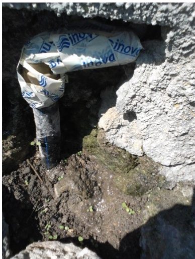
Figura 4.30 – Rotura na tubagem de ramal
