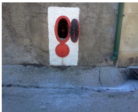
Figura 2.12 – Indícios de uso ilícito de água proveniente da boca de incêndio para fins de construção civil
