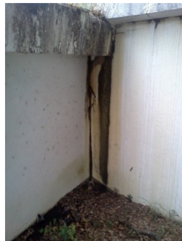
Figura 2.19 – Fissura no reservatório apoiado
