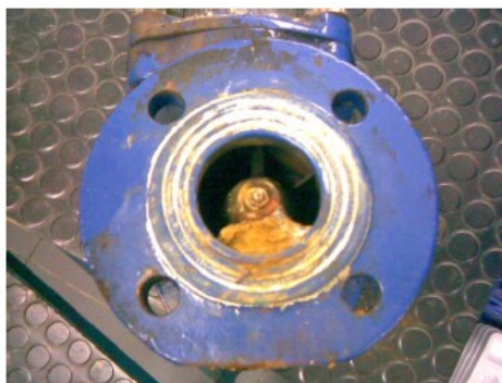
Figura 2.9 – Contador em mau estado de conservação (cedida por Joaquim Sousa)
