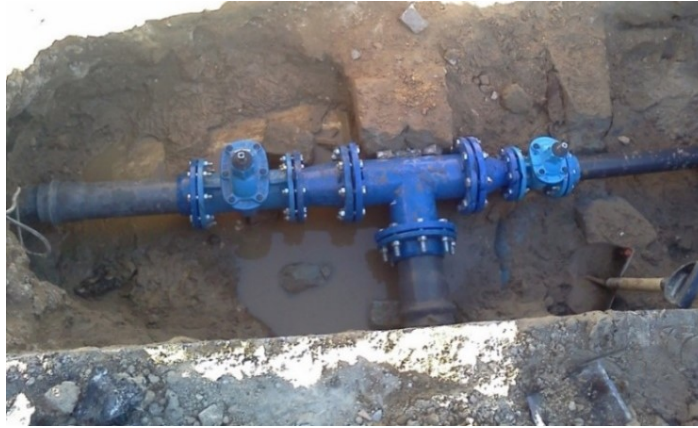
Figura 4.22 – Conjunto de válvulas novo, da rua do serradinho à saída do reservatório do Bolho
