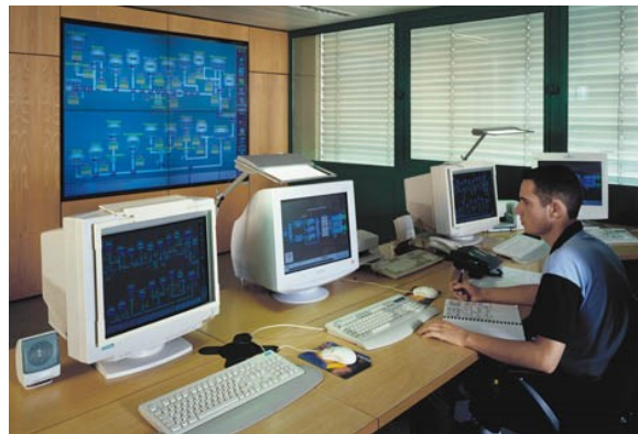
Figura 2.23 – Telegestão da ETA de Alcantarilha (Sul informação, 2012)
