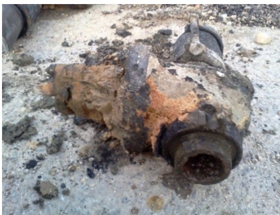
Figura 4.21 – Válvula antiga, a ser substituída
