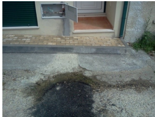
Figura 4.27 – Aparecimento de água à superfície num local anteriormente reparado
