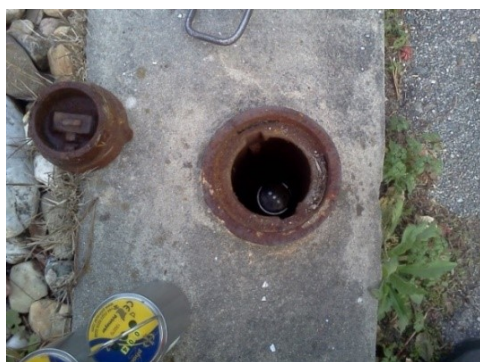
Figura 4.15 – Colocação do acelerómetro numa válvula de seccionamento
