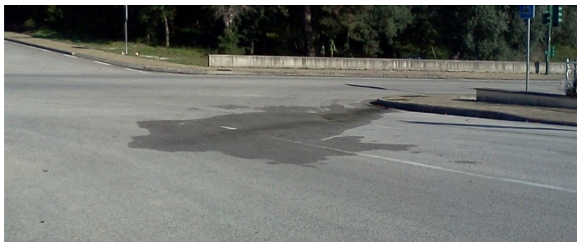
Figura 4.9 – Humidade anormal na estrada
