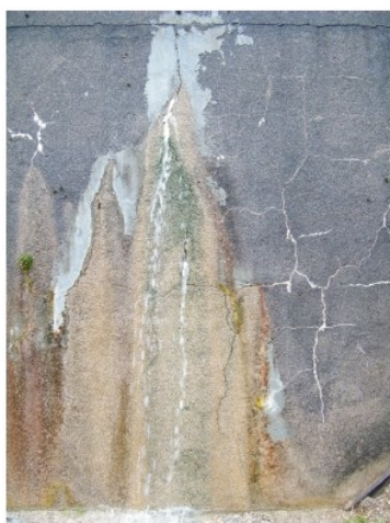
Figura 2.18 – Fissura no reservatório (cedida por Joaquim Sousa)
