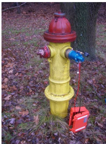
Figura 2.31 – Colocação do hidrofone numa boca de incendio (Vivax metrotech, 2009)
