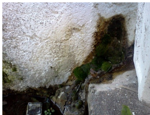
Figura 4.8 – Aparecimento de humidade e musgos na parede junto ao contador
