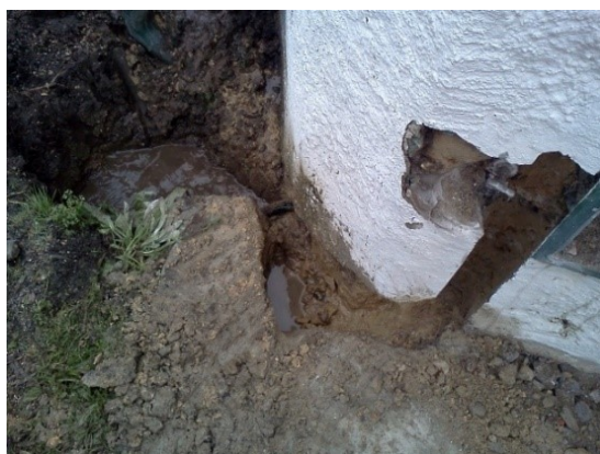
Figura 2.17 – Intervenção num ramal com o joelho danificado
