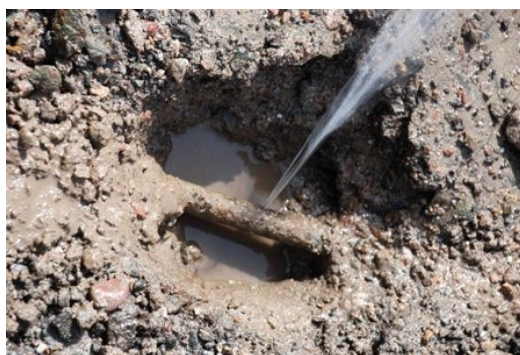
Figura 2.14 – Rotura na tubagem do ramal (Lakewood Water District, 2011)
