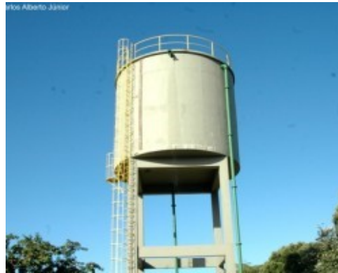
Figura 2.20 – Extravasamento do reservatório (PMA, 2010)
