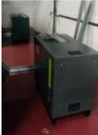
Figura 6.11 – Recuperadores de calor na nova sala de compressores; Fonte: Elaboração própria.
