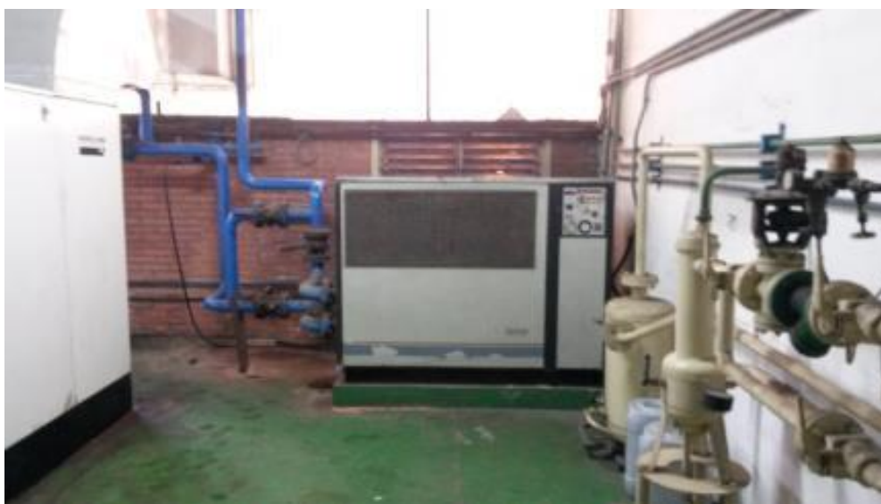
Figura 6.3 - Foto do inoperacional secador da instalação;
