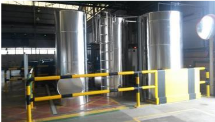
Figura 3.23 – Instalação de osmose do controlo final; Fonte: Elaboração própria.
