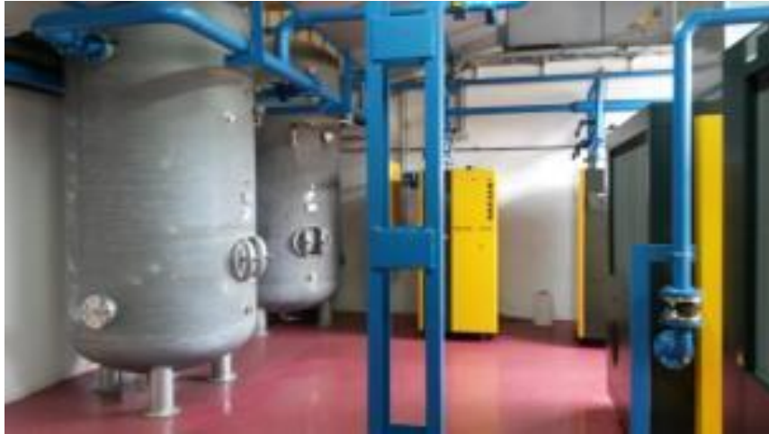
Figura 6.8 – Fotos da sala de compressores da rede de ar de 15 bar;
