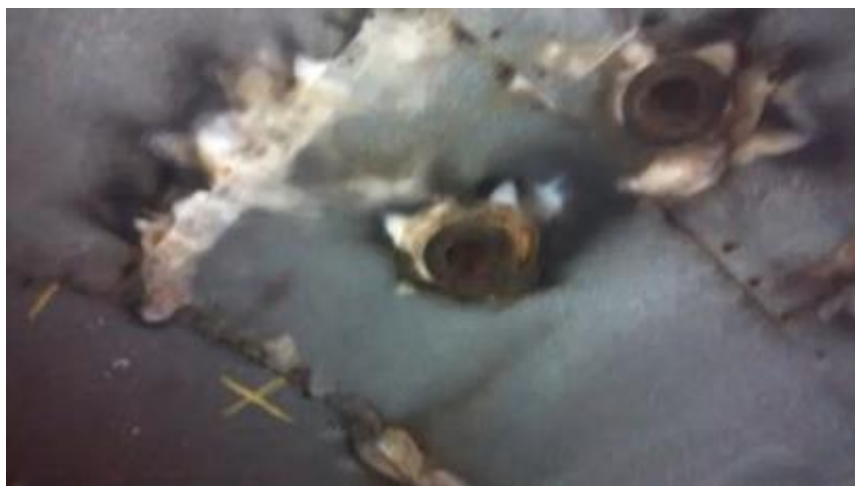
Figura 6.4 – Aspeto da entrada de ar do autoclave;
