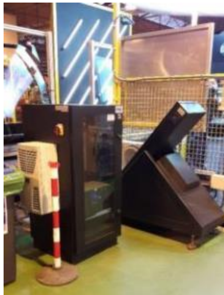
Figura 3.18 – Equipamento de controlo ótico Aura-Synergix da linha 2;
