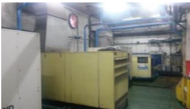
Figura 3.25 - Fotos dos equipamentos da instalação;
