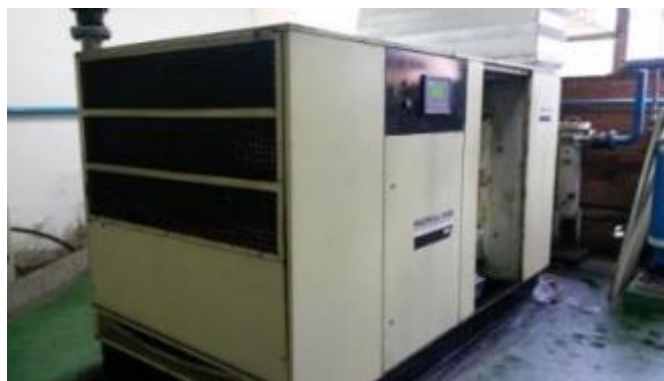
Figura 6.5 – Um dos compressores Ingersoll 170 kW;
