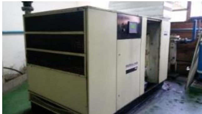
Figura 3.26 - Um dos compressores Ingersoll 170 kW;
