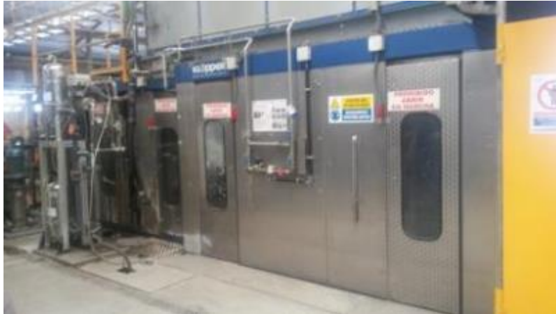
Figura 6.17 – Túnel de lavagem Klopper ;
