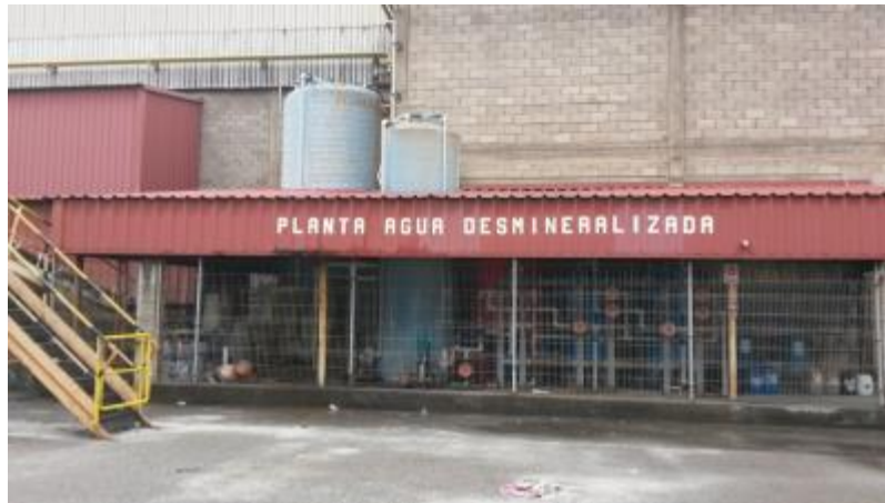
Figura 3.24 – Instalação de desmineralização da rede Nalco ;
