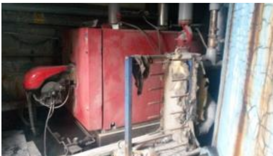
Figura 6.10 – Caldeira ROCA 930 kW;
