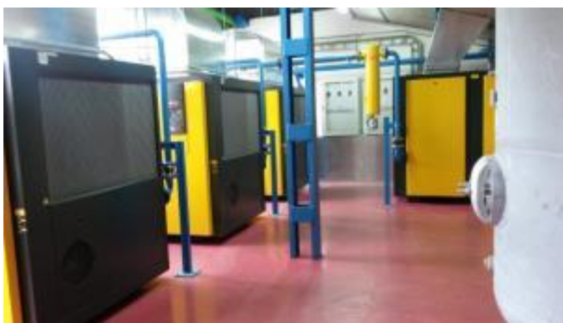
Figura 6.7 - Fotos da sala de compressores da rede de ar de 15 bar;
