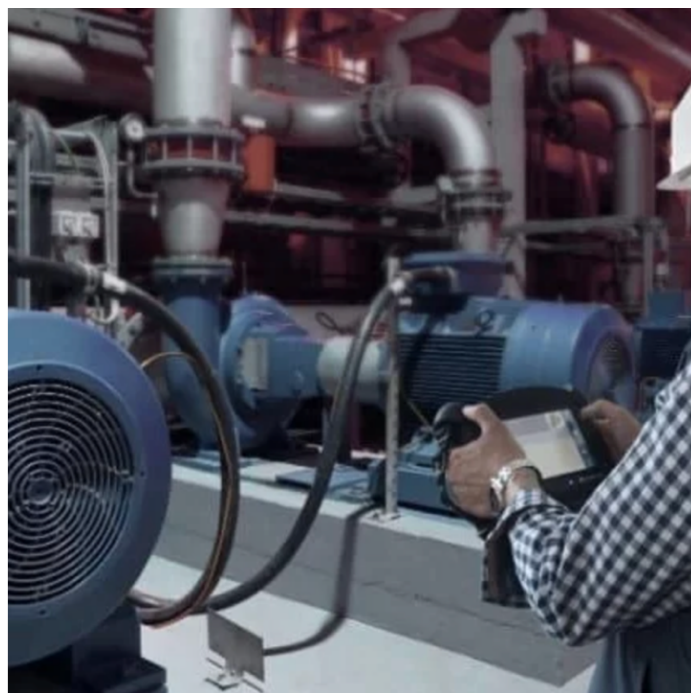
Figura 1 - Operador a realizar manutenção por controlo de condição (vibração) [54].
