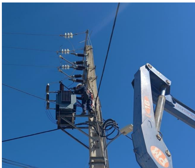
Figura 45 - Seccionador de facas aberto, para trabalhos em posto de transformação do tipo AII.
