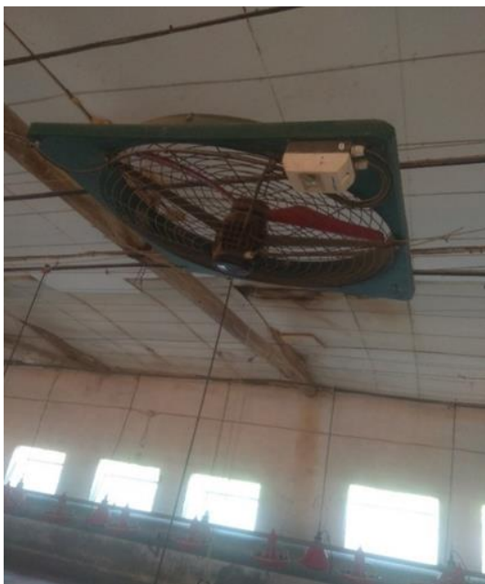
Figura 36: Ventilador de teto e janelas de ventilação natural
