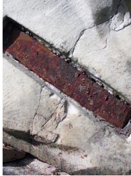
Figura 39- Fotografia, de pormenor, da escultura nº 2480 Esc. Visualização de um outro elemento metálico oxidado, “gato metálico”, existente na base da escultura.
