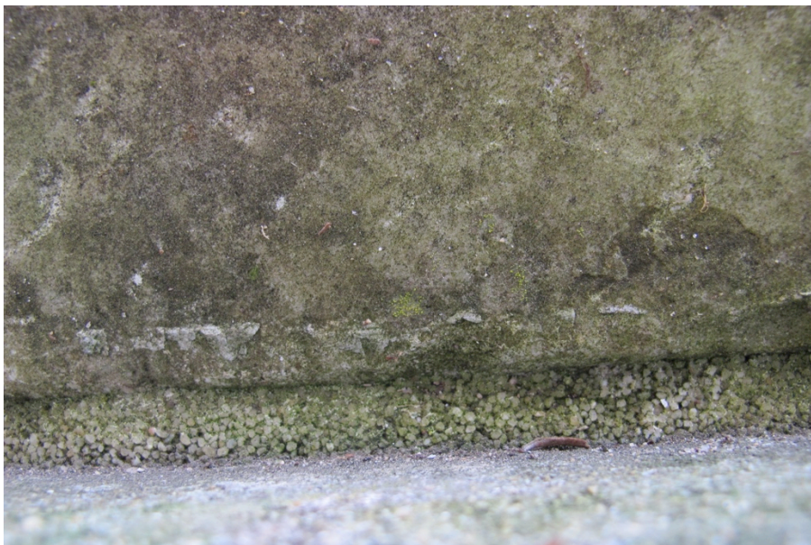
Figura 18- Pormenor da junta que une a peanha à base da escultura nº 773 Esc. Fotografia exemplificativa de uma argamassa com problemas de desagregação granular.
