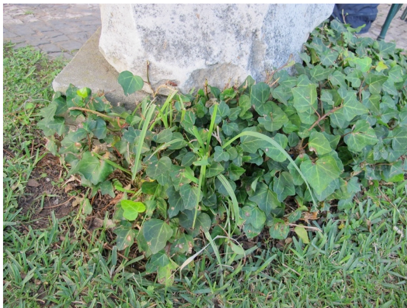
Figura 34- Fotografia, segundo vista posterior, da escultura nº 773 Esc. Identificação da patologia designada por vegetação. Na presente imagem, é possível verificar que a peanha se encontra parcialmente coberta por heras.
