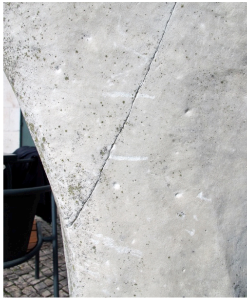
Figura 22- Fotografia da mesma fratura apresentada na figura anterior. Patologia vista segundo a vista posterior da escultura.
