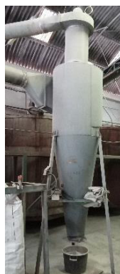
I: Ventilador de extração
