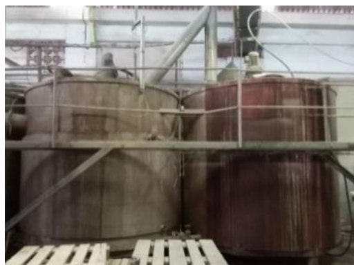
C: Tanque de hidrólise (à direita) e tanque de neutralização (à esquerda)
