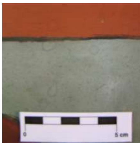
Figura 50 - Manchas na camada pictórica.
