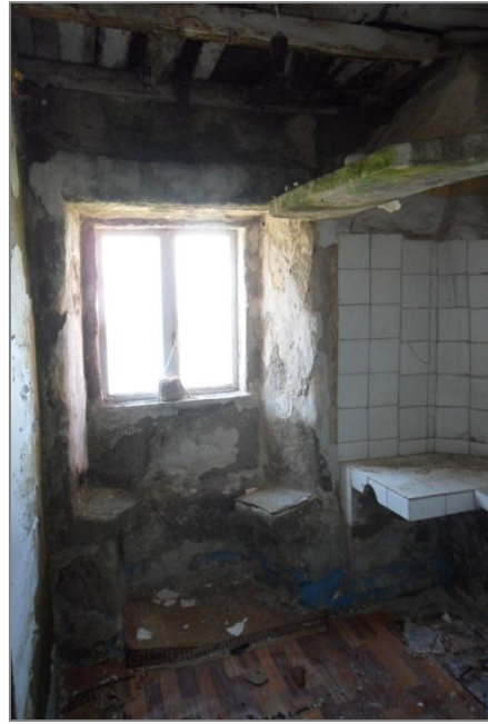
Fig. 99. Detalle de hueco ventana Caso 1.
