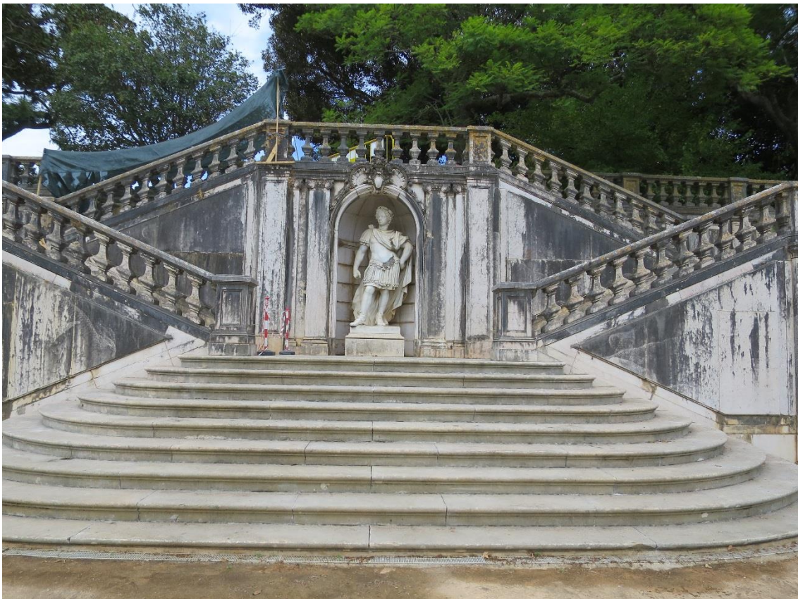
Imagem 1: Escadaria do JBA, com presença de biofilmes de cor escura, antes da recente intervenção de conservação e restauro. (Fonte: NC)
