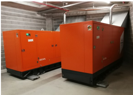
Fig. 9 – Geradores integrados no sistema de gestão técnica do edifício comercial
