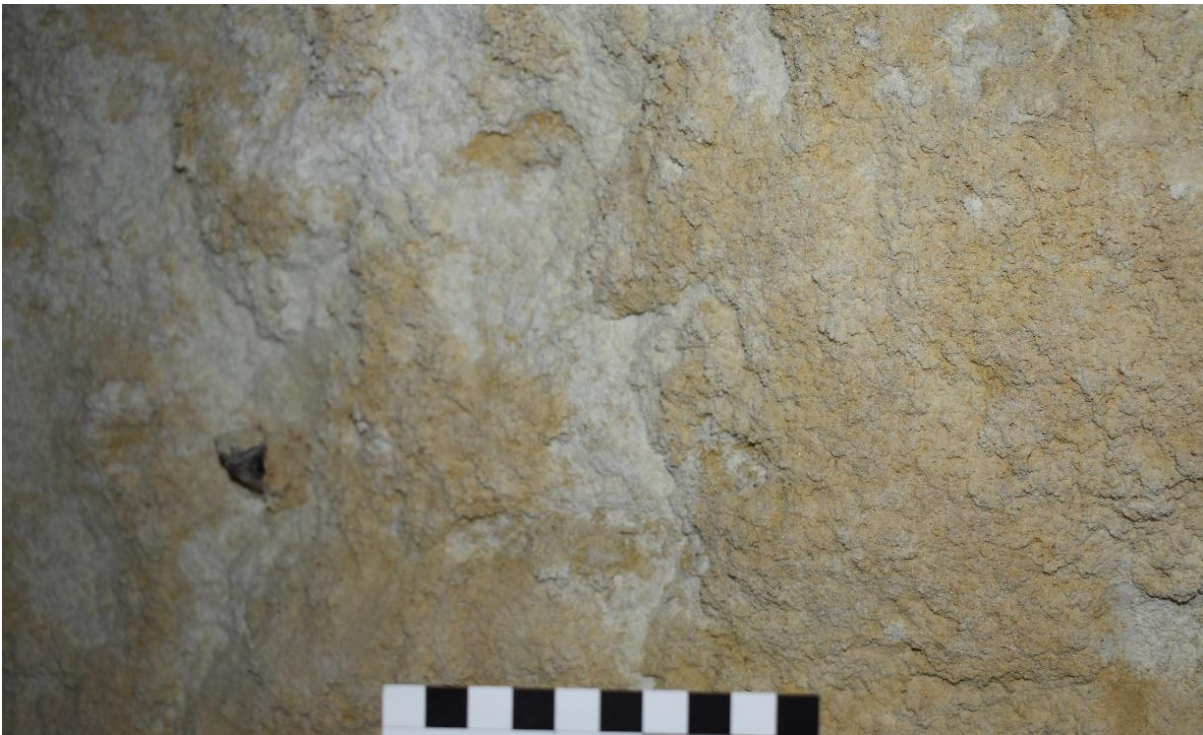
Annexe 8: Surface altérée de la cavité d'expérimentation (Photo: M. Calligaro)
