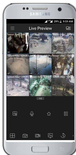
Figura 54 - Exemplo da aplicação CCTV
