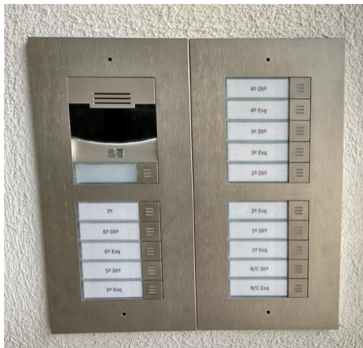
Figura 34 - Botoneira do prédio
