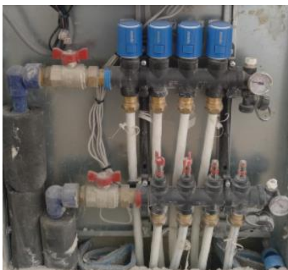
Figura 48 - Coletor do chão radiante
