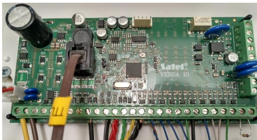
Figura 56 - Central de alarme Versa 10
