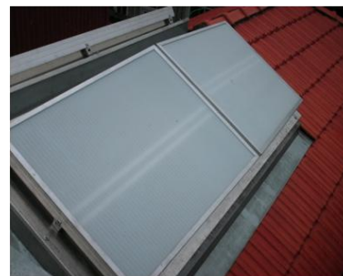
Figura 55 - Claraboias com sistema de desenfumagem
