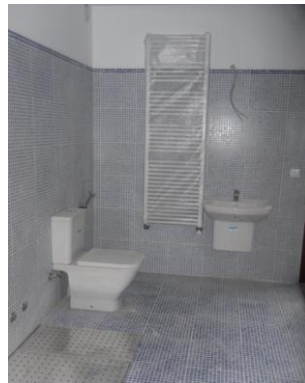
Figura 62 - Instalação sanitária devidamente equipada
