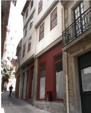
Figura 72 - Fachada principal do antigo edifício do Centro de Animação para a Infância e Lar de Idosos
