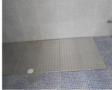
Figura 50 - Pormenor de piso rebaixado e nivelado com uma grelha metálica nas instalações sanitárias
