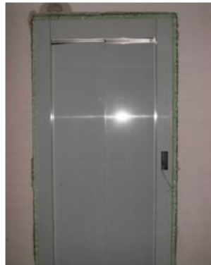
Figura 60 - Acesso vertical - elevador
