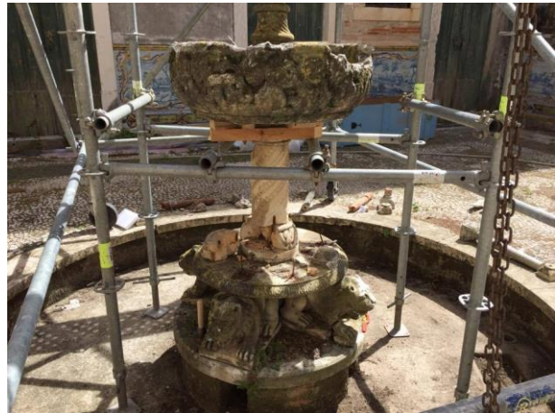
Figura 19. Estrutura metálica montada para suportar o bojo durante o procedimento de desmontagem. Foto: autoria do aluno.
