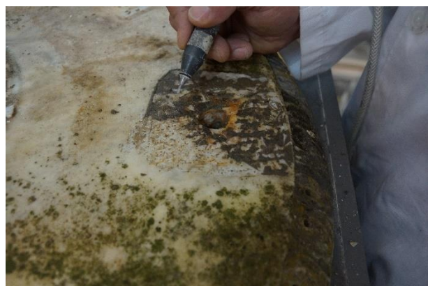
Figura 31. Remoção de argamassas do tipo cimento com recurso a vibro incisor. Foto: autoria do aluno.
