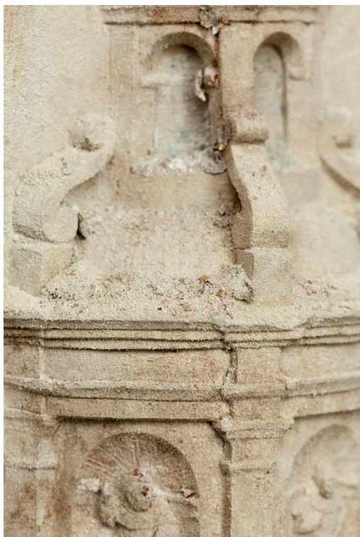
Figura 9. Depósito salino. Pormenor de pilastra do retábulo. Foto: Gonçalo Figueiredo, IPT.
