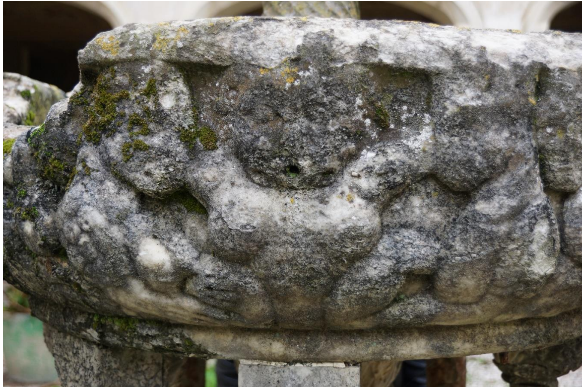
Figura 17. Colonização biológica do bojo e área de destacamento e desagregação granular. Foto: autoria do aluno.
