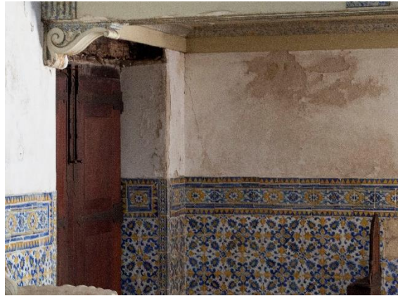
Figura 7. Aspeto de reboco desagregado. Foto: Gonçalo Figueiredo.
