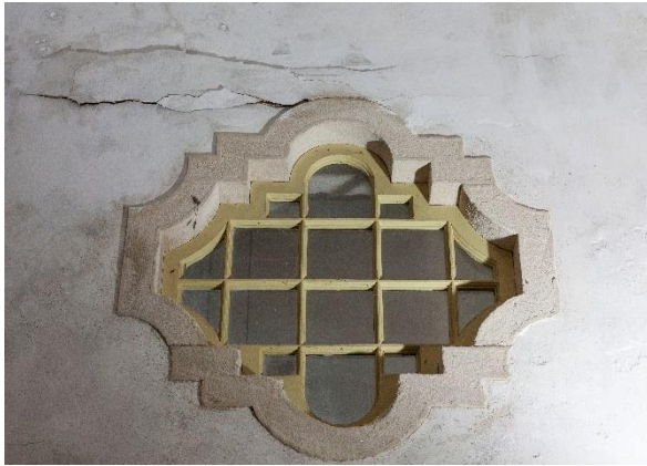
Figura 6. Fendas e fissuração do reboco da capela-mor. Foto: Gonçalo Figueiredo, IPT.
