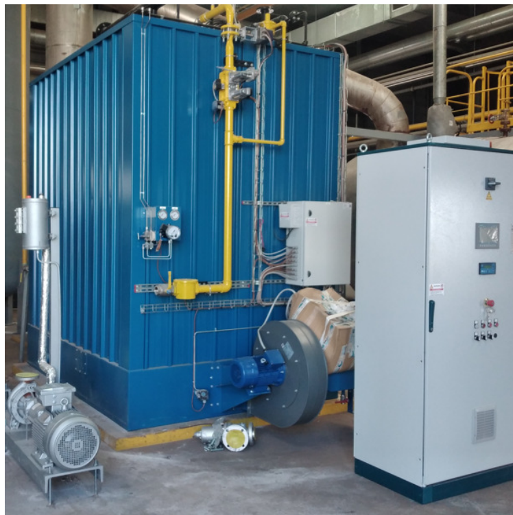
Figura 72. Caldeira instalada com bombas de recirculação e ventilador
