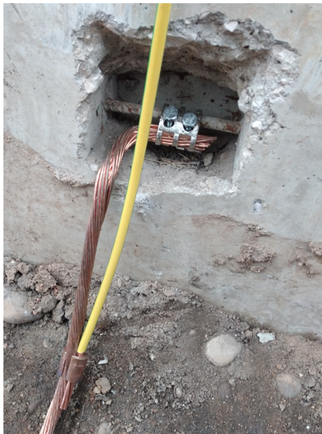
Figura 96. Pormenor da garra de fixação do cabo terra aos elementos estruturais do parque de tanques
