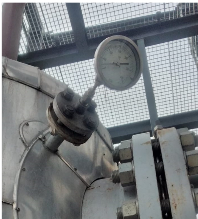
Figura 28. Exemplo de termómetro instalado
