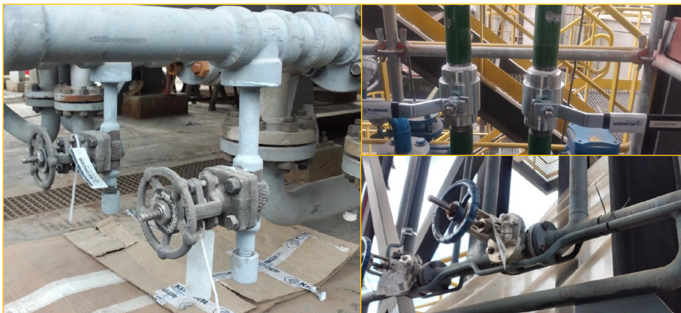
Figura 18. Válvulas de globo soldadas (esquerda), válvulas de globo flangeadas (direita inferior), válvulas de esfera (direita superior)
