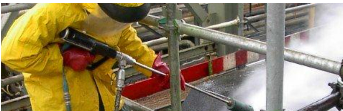
Figura 5. EGEO Pressão - Lavagens industriais [2]
