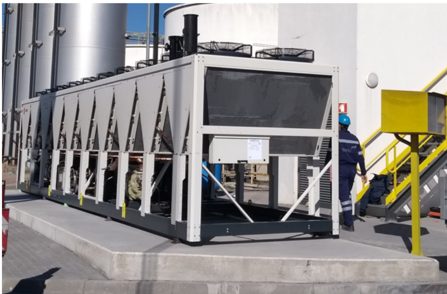
Figura 68. Equipamento para fornecer água gelada aos equipamentos do processo
