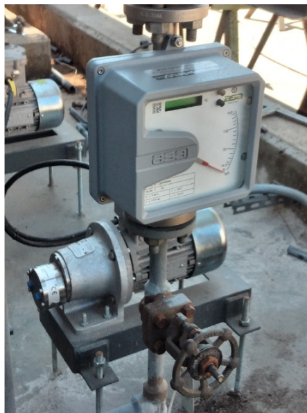
Figura 29. Exemplo de rotâmetro instalado
