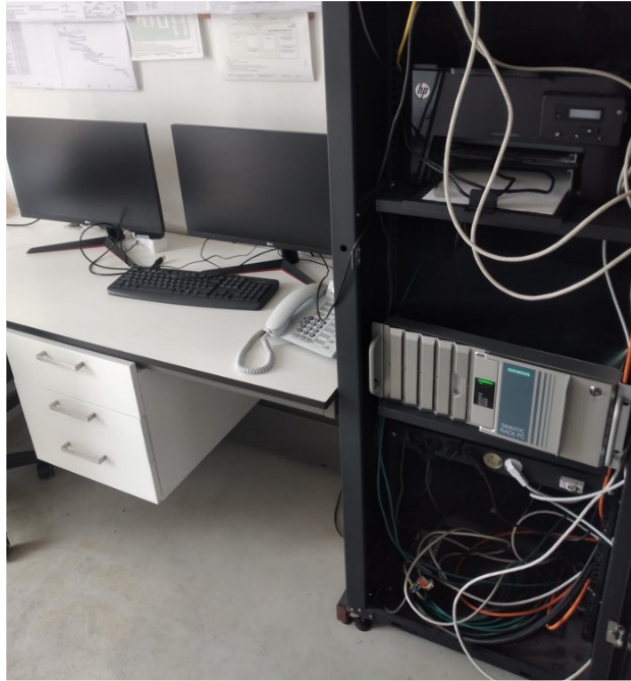
Figura 13. Sala de controle
