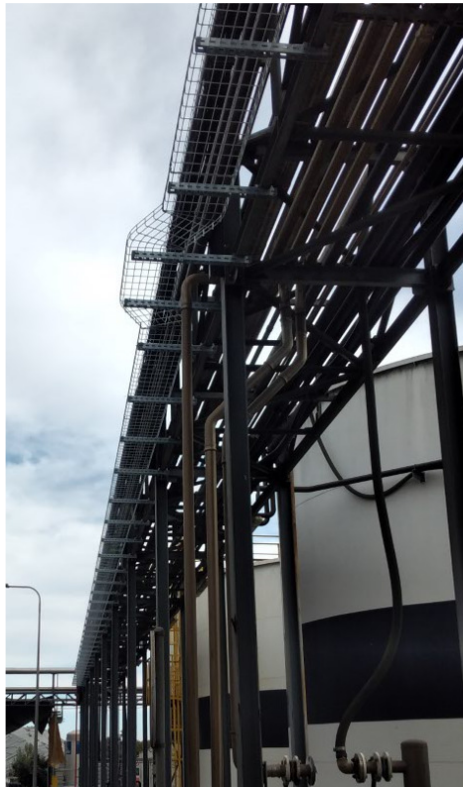
Figura 70. Esteira nova no lado esquerdo do pipe-rack (para passagem do cabo de alimentação do chiller
