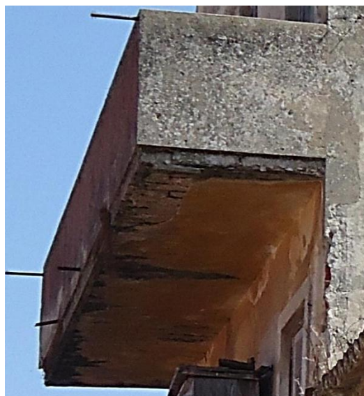
Figura 18 – Destacamento do recobrimento das armaduras da laje da varanda
