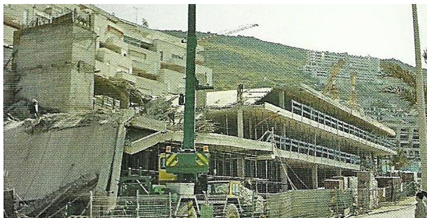
Figura 10 – Rotura por punçoamento. A ligação laje-pilar falhou. [Lopes, M.; 2008]
