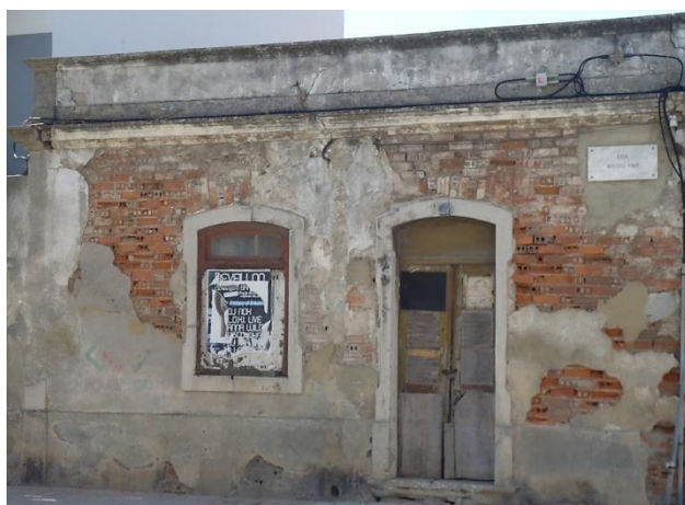
Figura 19 – Edifício degradado (exemplo: destacamento de reboco)
