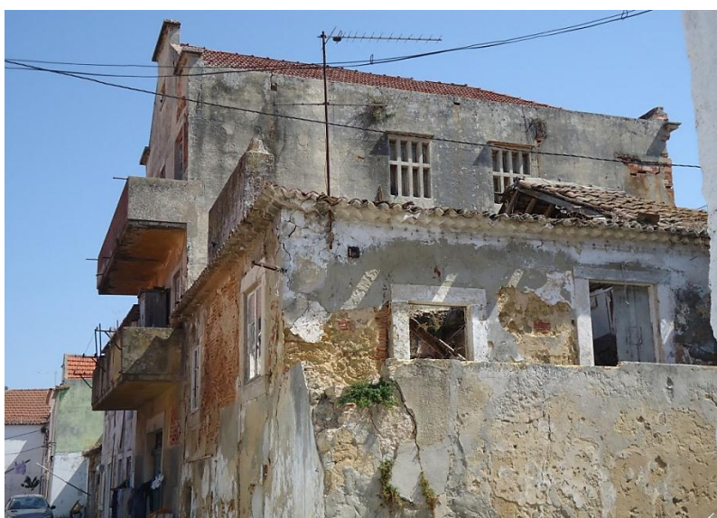
Figura 17 – Edifício em alvenaria degradado (Travessa Nova do Rosário)
