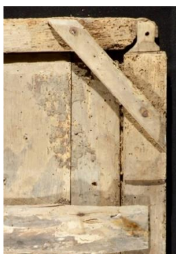
Figura 82 - Orifícios e áreas de perda matéria devido a um ataque de insetos xilófagos
