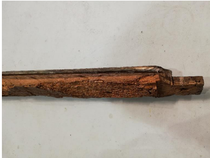
Figura 84 - Área de grande perda de matéria devido ao ataque de insetos xilófagos
