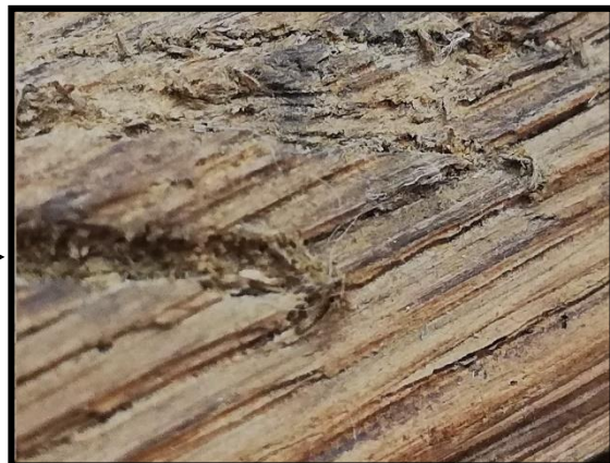
Figura 28 - Pormenor da madeira levantada na extremidade do corte
