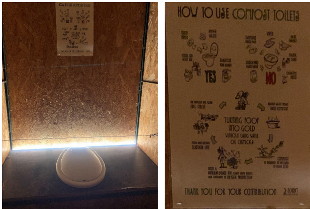
Figura 100 Interior do sanitário compostável
