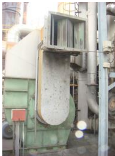
Figura 3.4.10 - Ventilador de Ar Secundário
