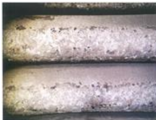
Figura 4.6.11 - Condições Superficiais dos Tubos no Interior da Serpentina (ISQ, 2014)
