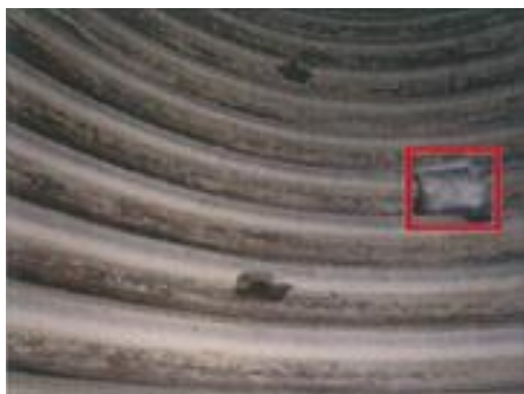
Figura 4.6.6 -Fissura Detetada na emenda do tubo n°67 a aproximadamente 90° (ISQ, 2014)
