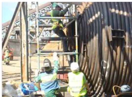
Figura 4.1.26 - Soldaduras das Tubagens de Saída de Óleo (Superiores)
