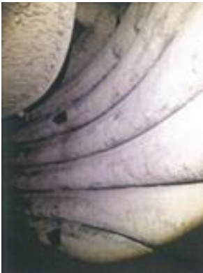
Figura 4.6.12 - Condição dos Tubos da Serpentina Exterior na Inversão para a 2ª Passagem de Gases (ISQ, 2014)
