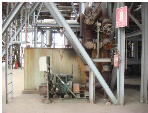
Figura 3.4.8 - Sistema de Arrefecimento de Emergência
