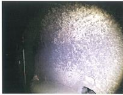
Figura 4.6.9 - Condição do Refratário da Parede Lateral Direita (ISQ, 2014)
