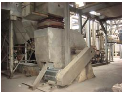
Figura 3.4.11 - Ventilador de Tiro nº1
