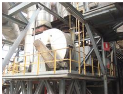
Figura 3.4.12 - Ventilador de Tiro nº2
