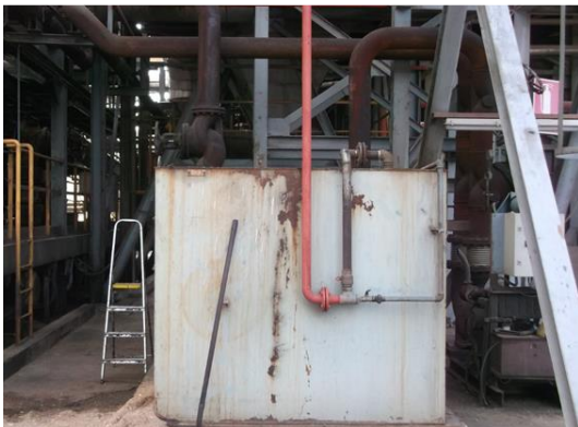
Figura 4.5.1 - Tanque de Arrefecimento de Óleo
