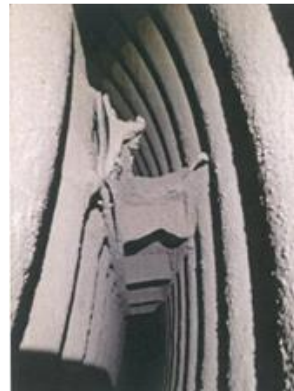
Figura 4.6.13 - Desgaste de um dos Espaçadores entre a Serpentina Interior/Exterior (ISQ, 2014)
