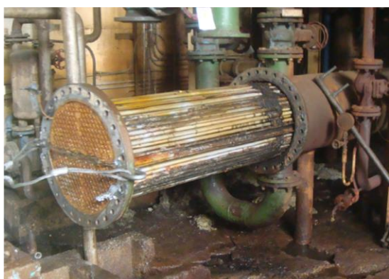
Figura 4.9.1 - Serpentina do Permutador de Condensados
