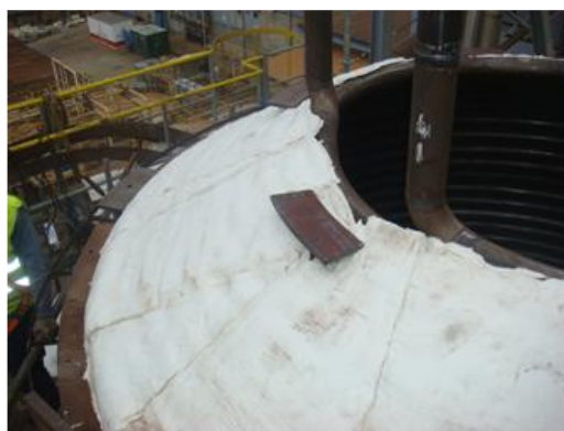
Figura 4.1.36 - Isolamento da Serpentina
