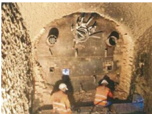
Figura 4.6.2 - Parede Frontal antes da Respetiva Beneficiação
