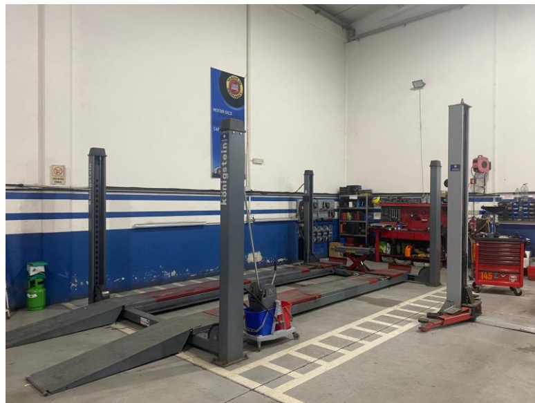
Figura 5: Oficina: Zona de elevadores dos carros
