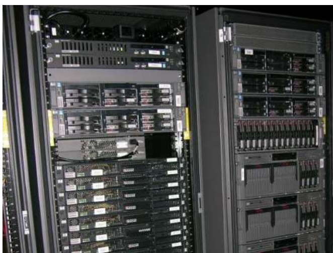
Figura 10 - Conjunto de bastidores de rack num CD (Cisco)
