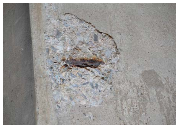
259. Fisura por carbonatación (oxidación armadura)
