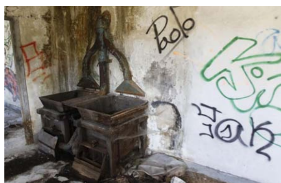
221. Interior dañado por filtraciones y vandalismo
