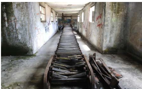
266. Revestimiento interior en mal estado
