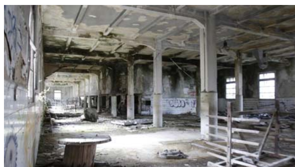
240. Estructura afectada por humedades
