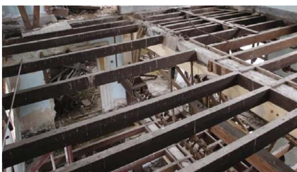
245. Forjado de madera prácticamente destruido
