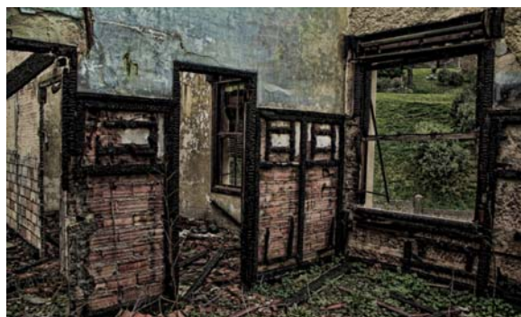
217. Interior de las oficinas calcinadas
