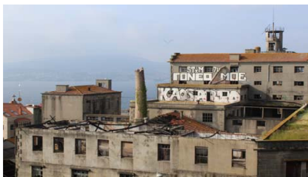
216. Cubiertas de las oficinas y archivo calcinadas
