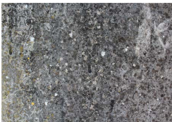
258. Musgos y líquenes en muro exterior
