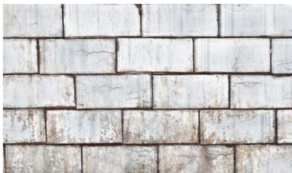
270. Detalle estado del alicatado
