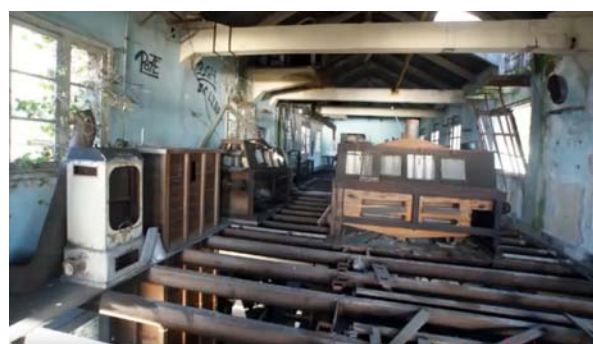
246. Forjado de madera muy deteriorado
