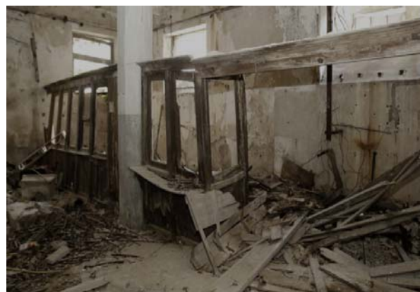
272. Particiones de madera destruidas
