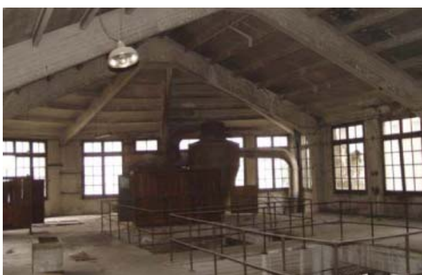
133. Planta superior con maquinaria de aspiración
