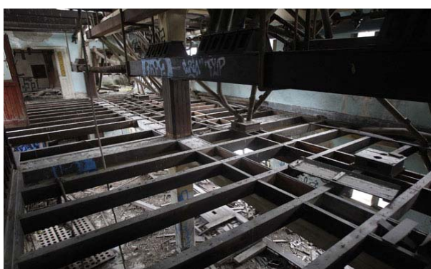
220. Forjados totalmente destruidos por filtraciones
