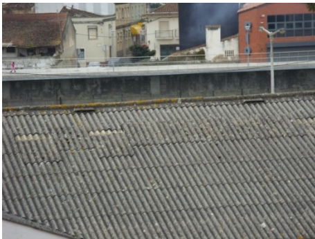
Figura 64 – Escorregamento de placas de fibrocimento e manchas, Sara Lopes (2013)
