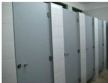
Figura 48 – Aspeto das novas portas em compacto fenólico [18]
