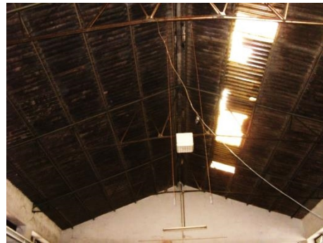
Figura 65 – Escorregamento de placas de fibrocimento observado no interior do edifício, Sara Lopes (2013)
