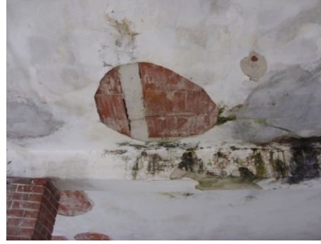
Figura 61 – Queda do revestimento inferior da cobertura, Sara Lopes (2013)
