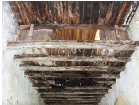
Figura 89 – Pavimento degradado, Sara Lopes (2013)
