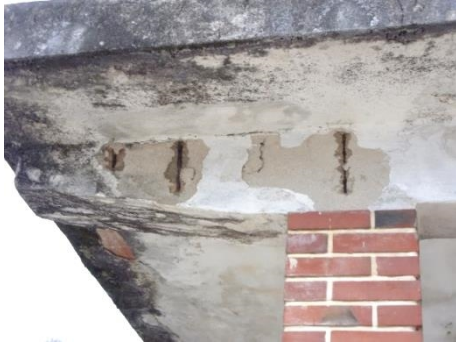
Figura 60 – Destacamento de betão e armaduras à vista, Sara Lopes (2013)
