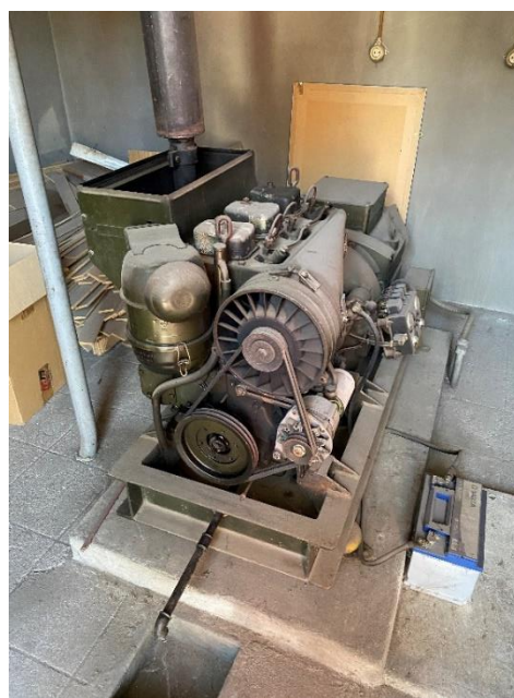
Figura 5.32 - Gerador em mau estado de conservação
