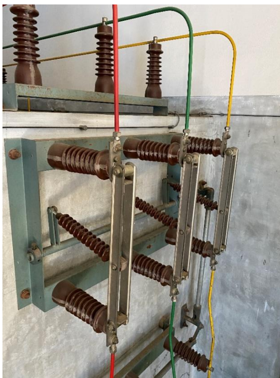
Figura 5.4 - Seccionador média tensão
