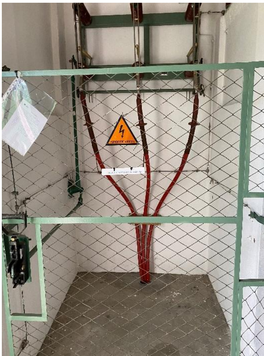
Figura 5.3 - Entrada de média tensão
