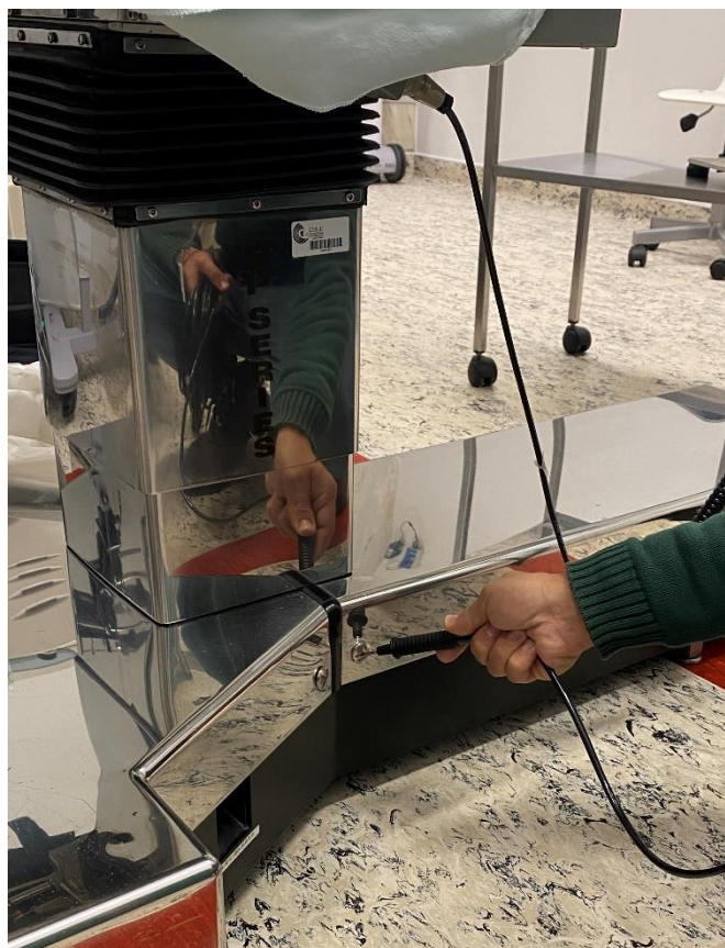
Figura 5.51 - Verificação equipotencialidade mesa cirúrgica
