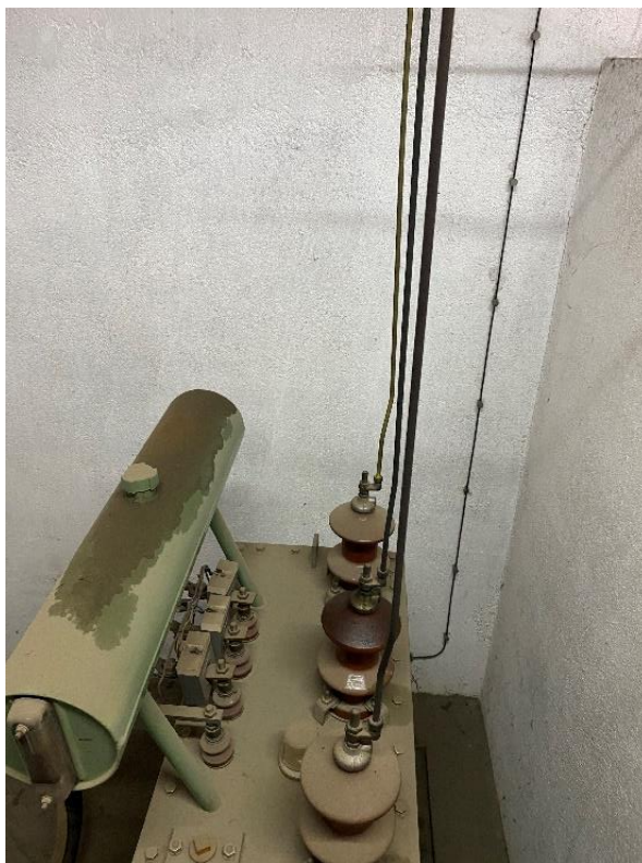
Figura 5.14 - Transformador com fugas 1
