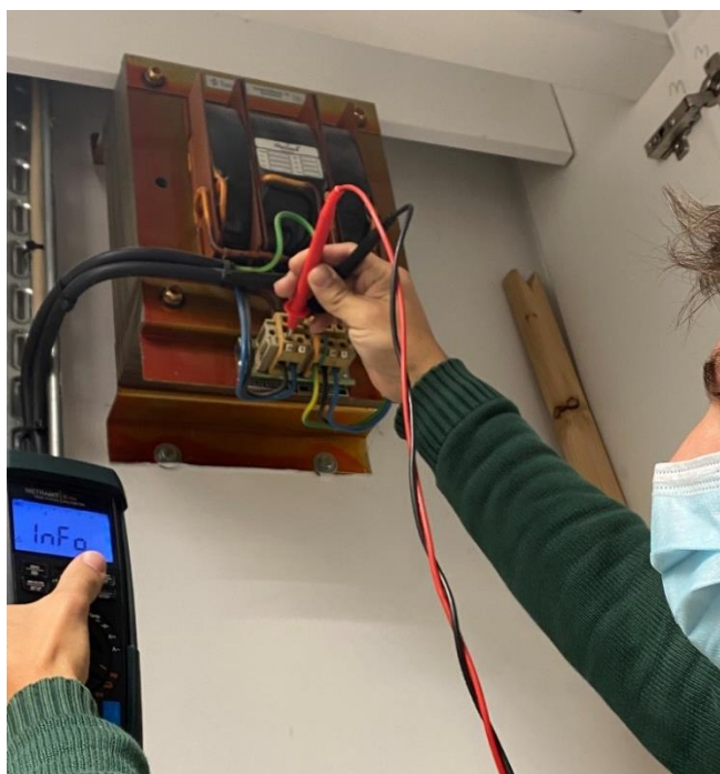
Figura 5.45 - Medição das correntes de fuga
