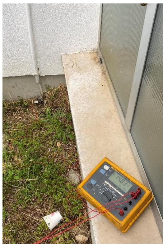
Figura 5.38 - Medição para-raios (não conforme - maior que 10 Ohm)
