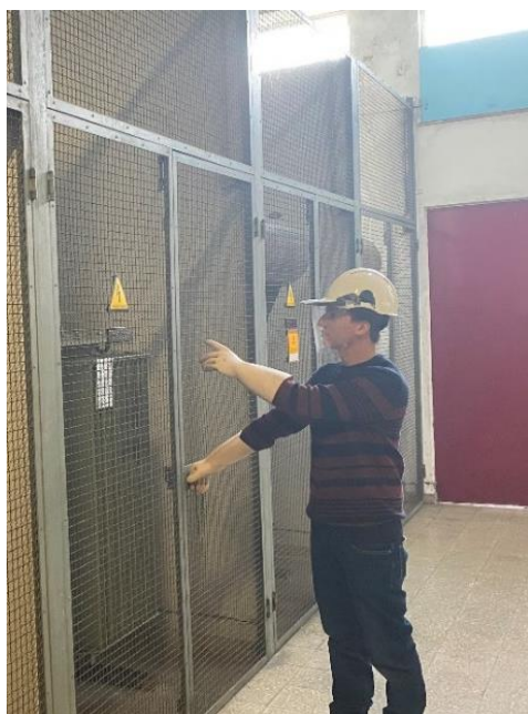
Figura 5.10 - Análise visual ao Transformador
