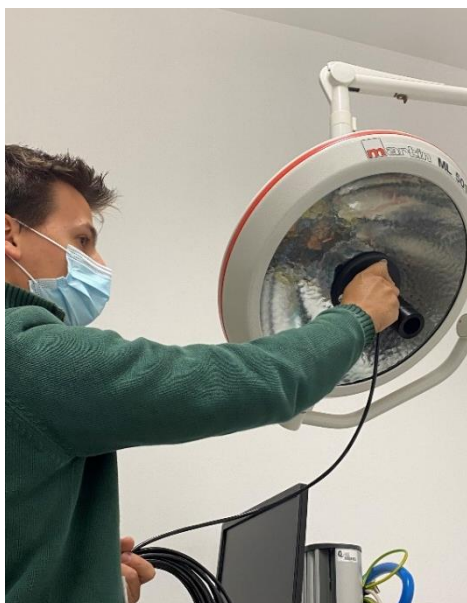
Figura 5.50 - Verificação equipotencialidade candeeiro cirúrgico
