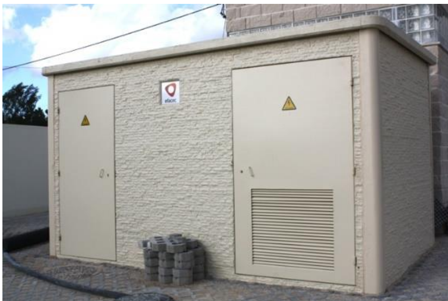
Figura 3.3 - Posto de Transformação CB
