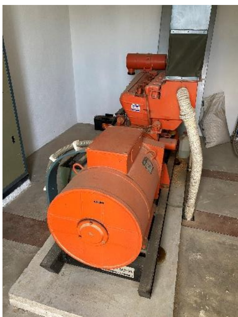
Figura 5.31 - Grupo Gerador com 1 Gerador
