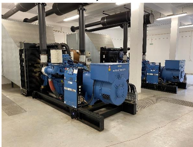
Figura 5.30 - Grupo Gerador com 2 Geradores
