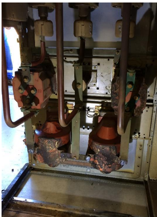
Figura 5.9 - Cella QM danificada
