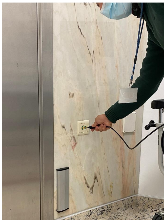
Figura 5.52 - Verificação equipotencialidade ponto terra
