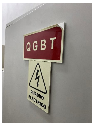
Figura 5.28 - Identificação Quadro Elétrico
