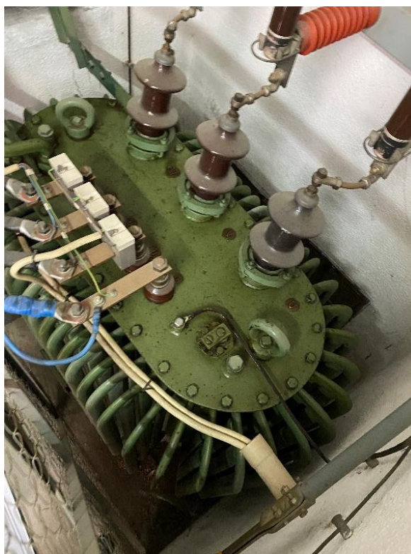
Figura 5.15 - Transformador com fugas 2
