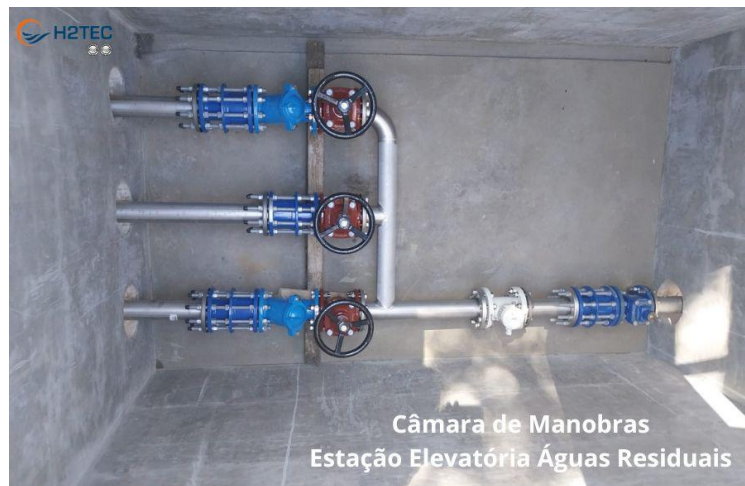
Figura 10 - Tubagens câmara de manobras
