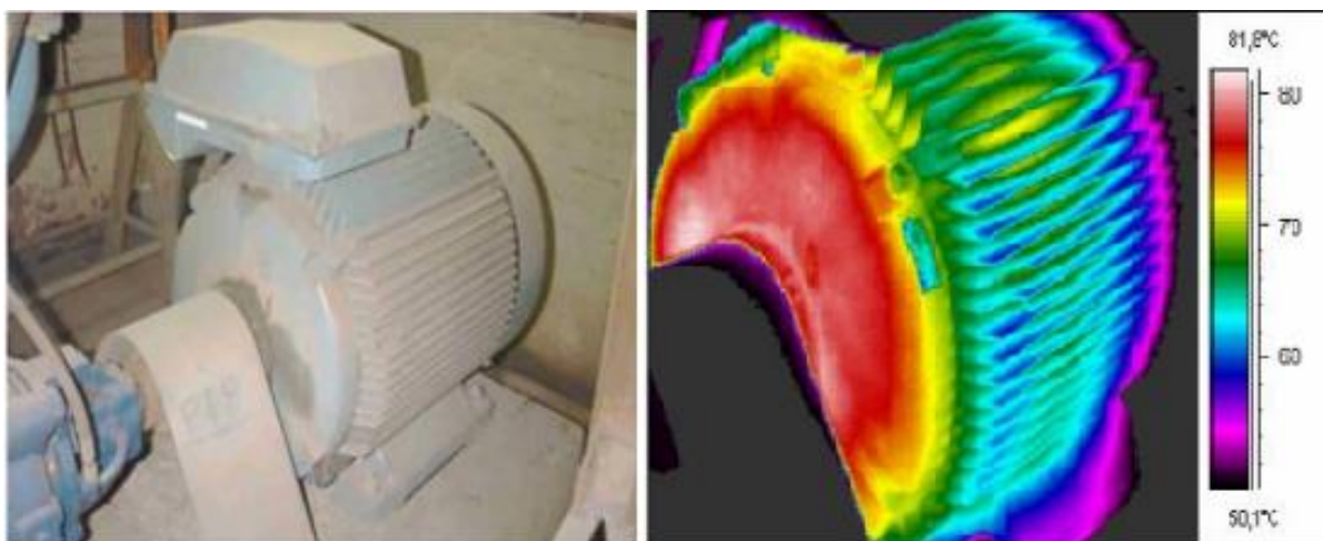
Figura 40 – Detecção de falha na zona dos rolamentos do motor elétrico [49].
