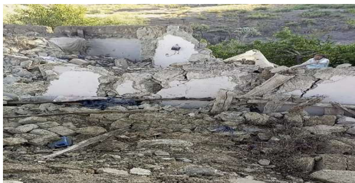
Figura 1 - Edifício destruído por sismo no leste do Afeganistão, em 22 de junho de 2022 [4].
