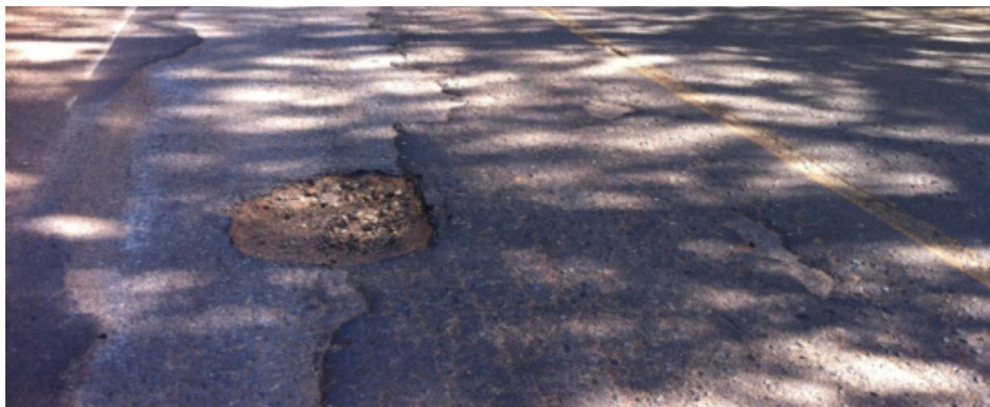
Figura 4.8 Cova num pavimento rodoviário (DER/SP, 2012).
