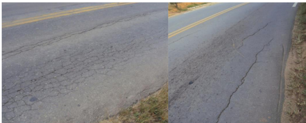
Figura 4.5 Fendas interligadas (esquerda) e fendas isoladas (direita) (DER/SP, 2012)
