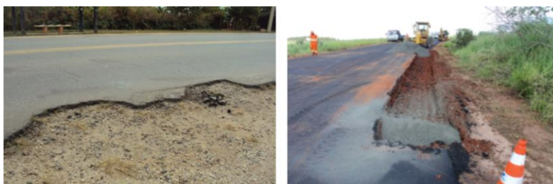
Figura 4.7 Danificação de pavimento causado por agravamento da rotura do bordo (DER/SP, 2012).
