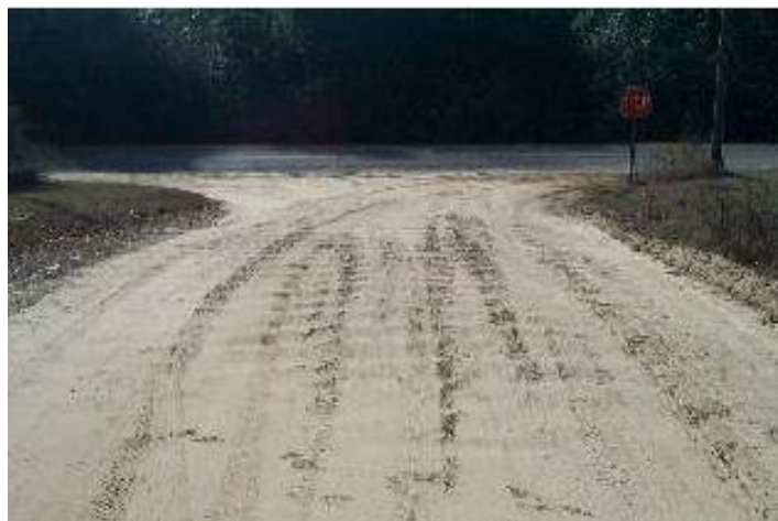
Figura 4.11 Pavimento não selado, ondulações (Fatorri, 2007)
