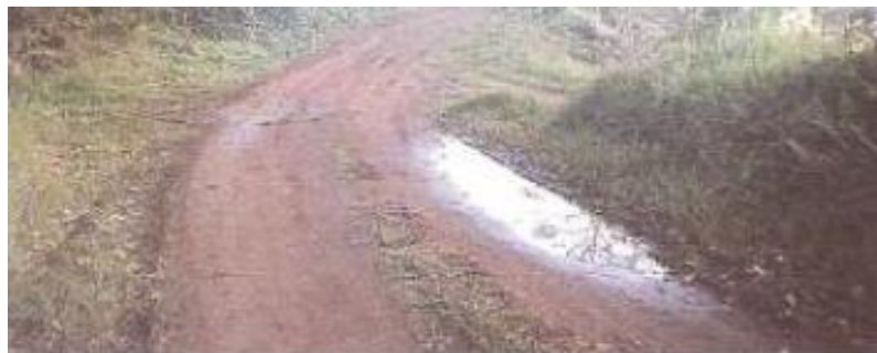
Figura 4.10 Drenagem inadequada (Fattori, 2007)
