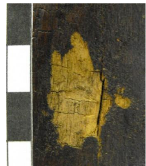
Fig. 94 – Zona de desintegração da Madeira em forma cúbica na escultura n° 1270. A autoria própria.
