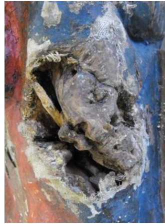
Fig. 117 – Concluída a remoção d pasta de preenchimento do joelho da Virgem da escultura nº 1334, pondo em evidência um defeito da madeira. Autoria própria.
