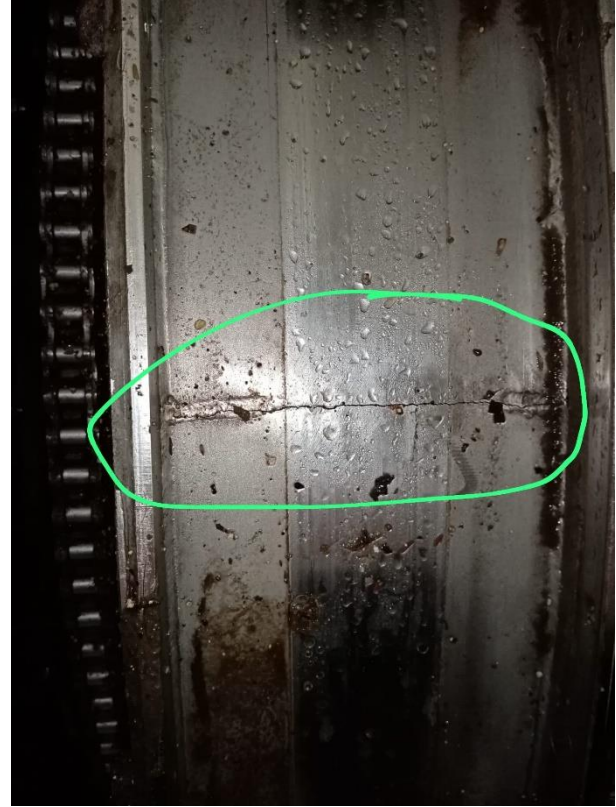
Figura 5.7 – Rachaduras na zona próxima ao motor
