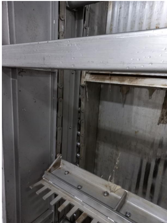
Figura 5.4 – Corrente da grade mecânica com avaria
