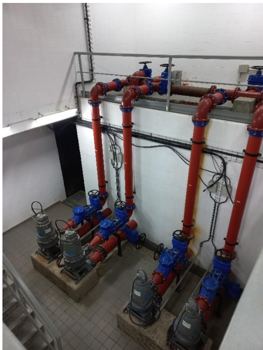
Figura 4.4 – Sistema de bombagem da estação elevatória do Areeiro
