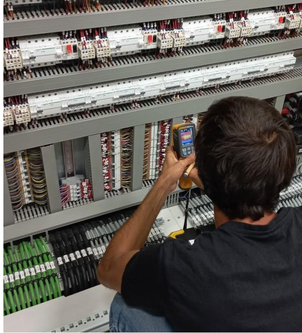
Figura 5.8 – Análise termográfica nos quadros elétricos da ETAR do Funchal
