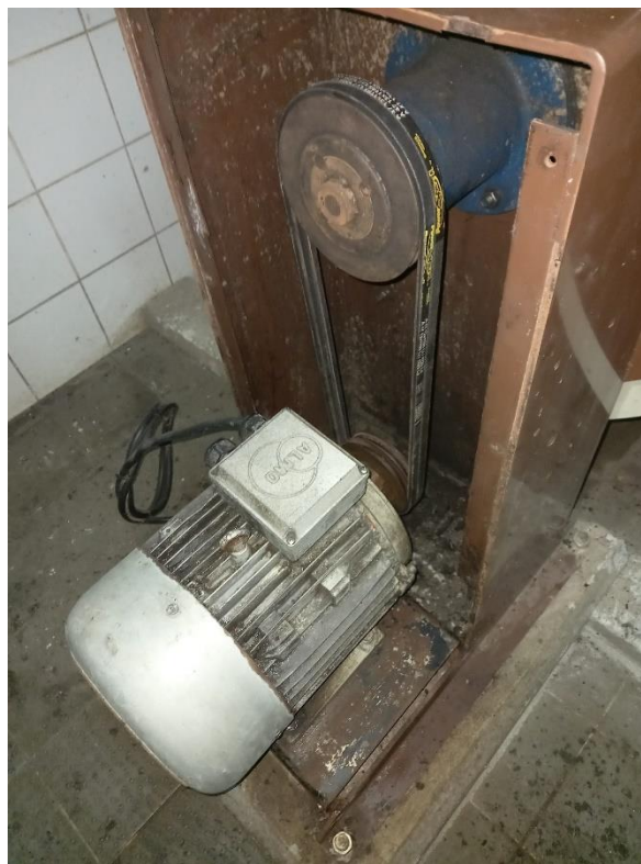
Figura 5.5 – Correias do ventilador
