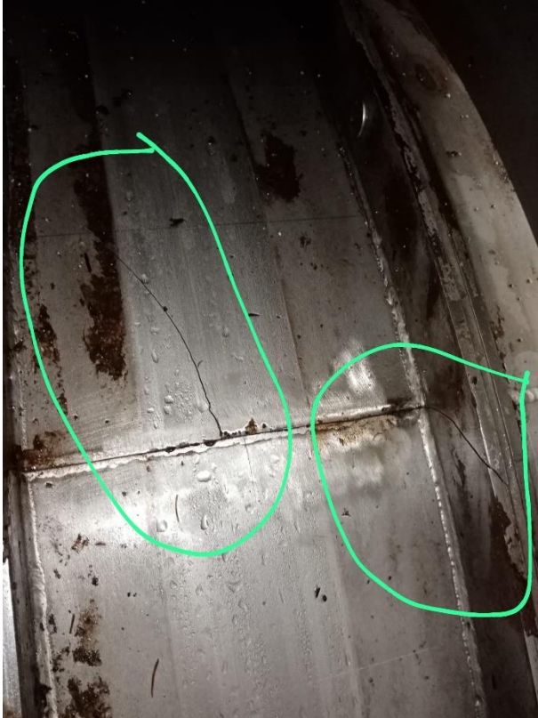
Figura 5.6 – Rachaduras da zona mais afastada do motor
