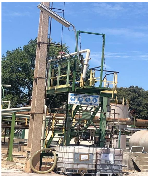
Figura 12 - Instalação de Filtração e Recuperação de Solução amoniaca impura
