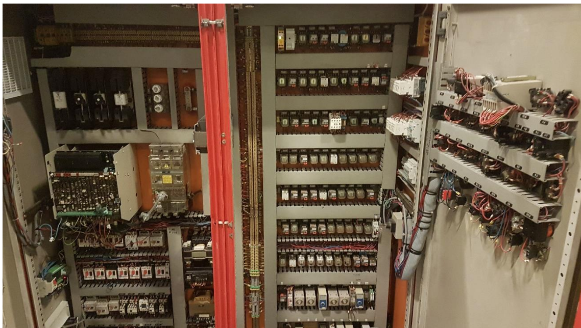
Figura 3 - Exemplo de quadro elétrico antes dos autómatos
