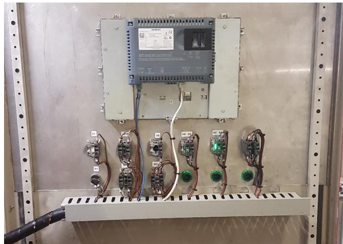
Figura 44 - Interior da porta do quadro elétrico depois do upgrade
