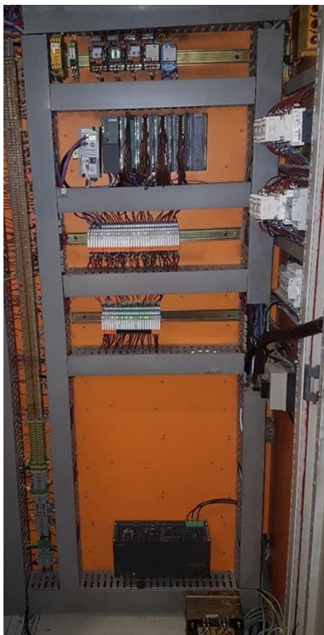
Figura 43 - Interior do quadro finalizado
