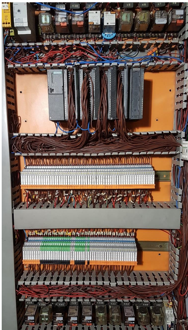
Figura 31 - Fase com 4 linhas de relés removidas
