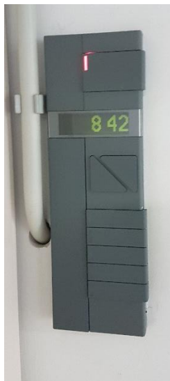
Figura 51 - Consola de controlo do sistema de domótica
