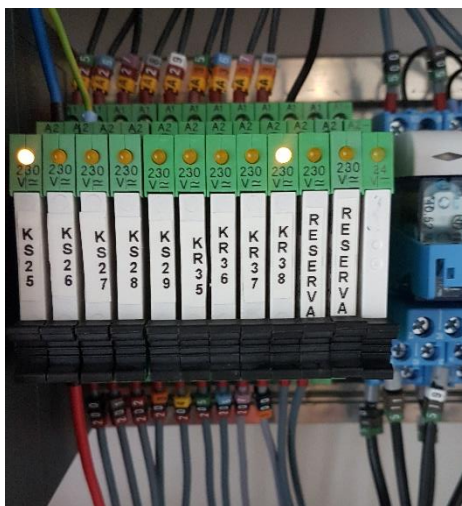
Figura 59 - Relés de interface das entradas do PLC
