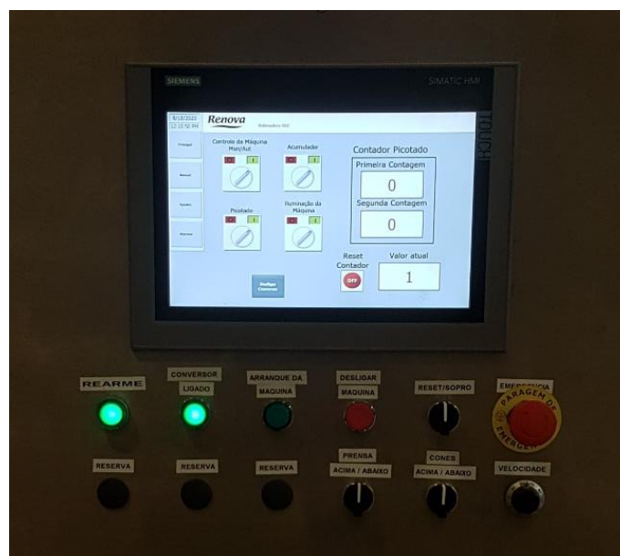
Figura 45 - Exterior da porta do quadro elétrico depois do upgrade
