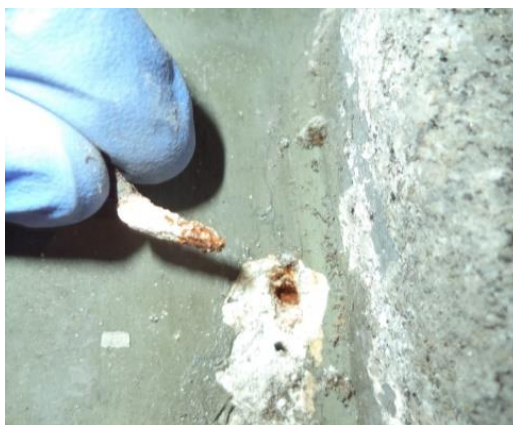
Figura 91- Fotografia ao pormenor do elemento metálico oxidado. Fonte: autoria própria;
