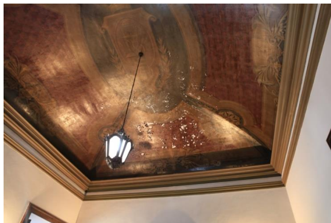
Figura 13- Fotografia do teto da antecâmara antes da intervenção. Fonte: autoria própria;
