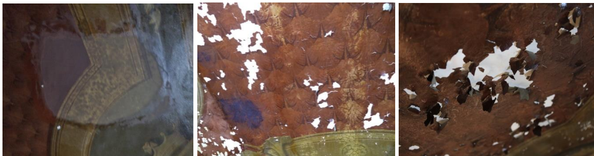
Figura 26, 27 e 28- Fotografias a pormenores do repinte, alteração de cor e destacamentos da camada policroma no teto da antecâmara. Fonte: autoria própria;
