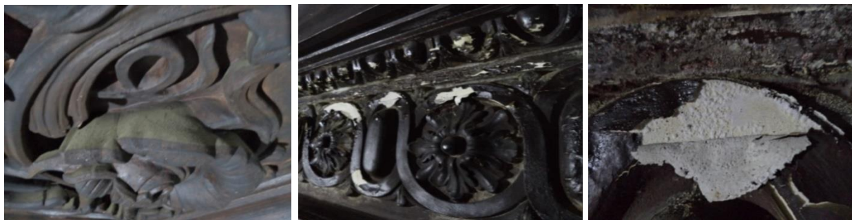
Figura 34, 35 e 36- Fotografias a pormenores de sujidade, destacamentos e presença de sais solúveis no teto da escadaria. Fonte: autoria própria.
