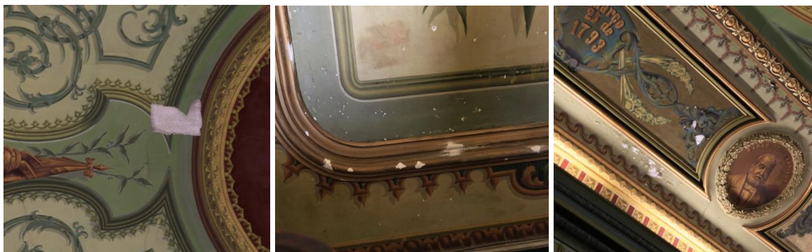
Figura 30, 31 e 32- Fotografias de pormenores de lacunas volumétricas, destacamentos e sujidade. Fonte: autoria própria;
