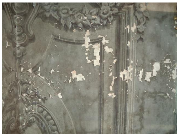
Figura 94- Fotografia de pormenor de destacamento, lacunas e desgaste. Fonte: autoria própria;
