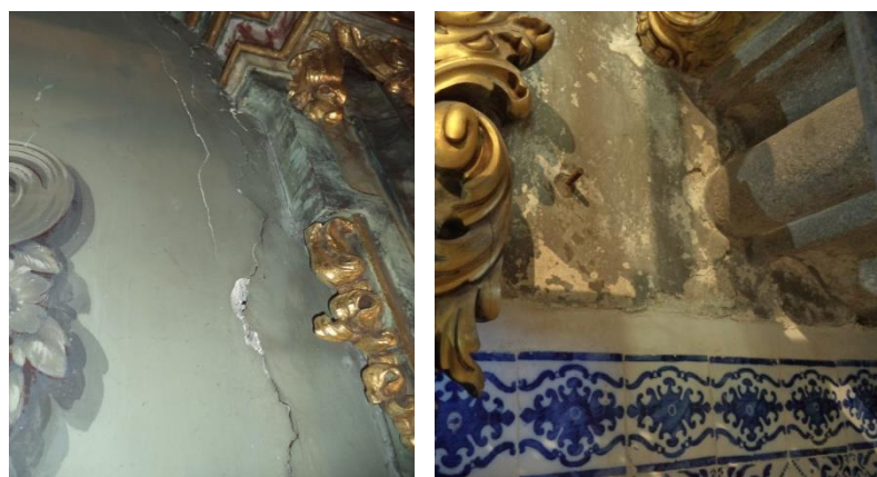
Figura 92 e 93- Fotografias de pormenor dos fendilhamentos e da presença de sais solúveis. Fonte: autoria própria;
