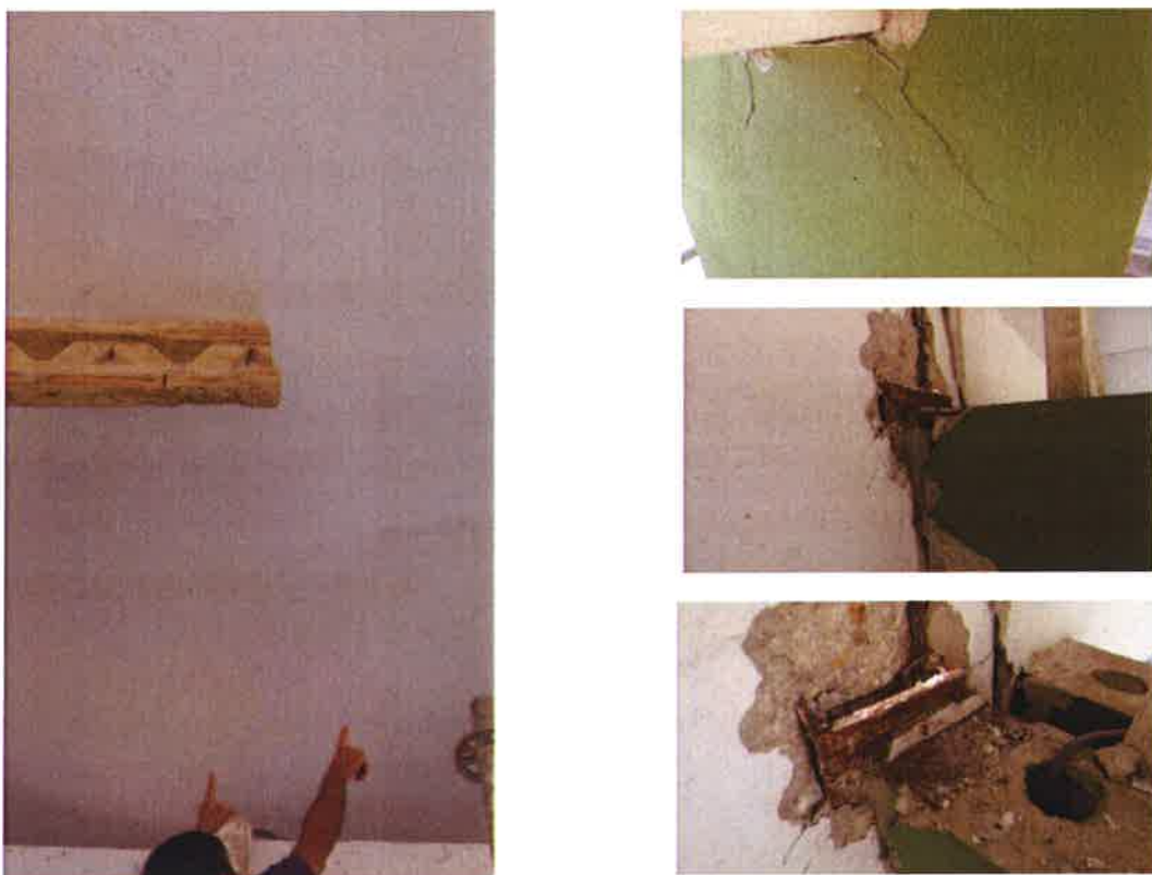
Figura 3.12 – Verificação dos danos na estrutura
