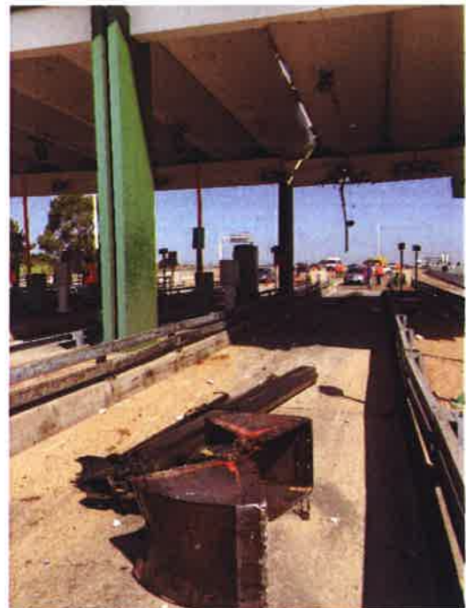
Figura 3.7 – Danos na estrutura (b)
