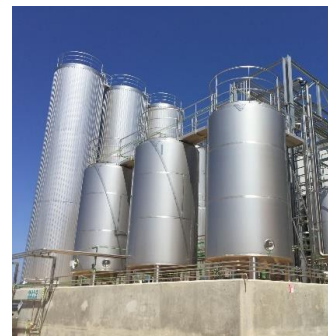
Figura 21 - Conjunto de reservatórios de armazenagem.
