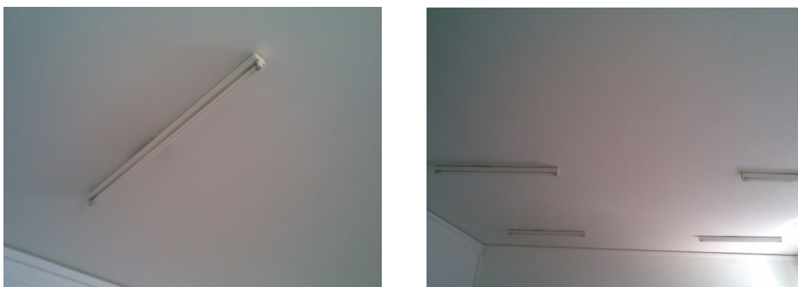
Figura 4. 1 – Luminárias atuais das salas de aula.
