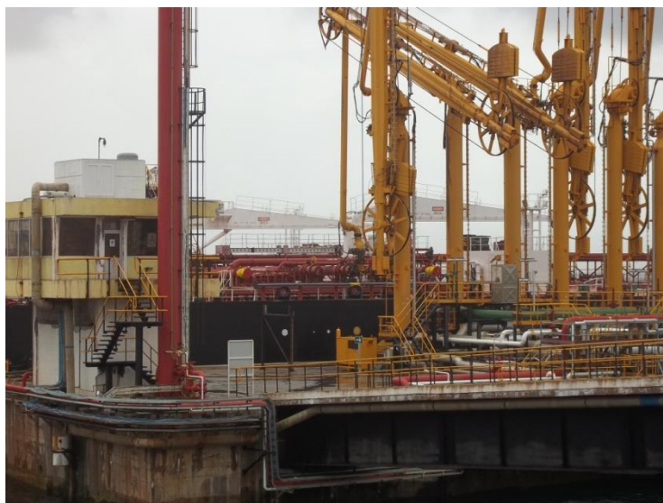
Ilustração 5 - Braços de carga do terminal, ligados ao navio, para carga/descarga de hidrocarbonetos ou resíduos
