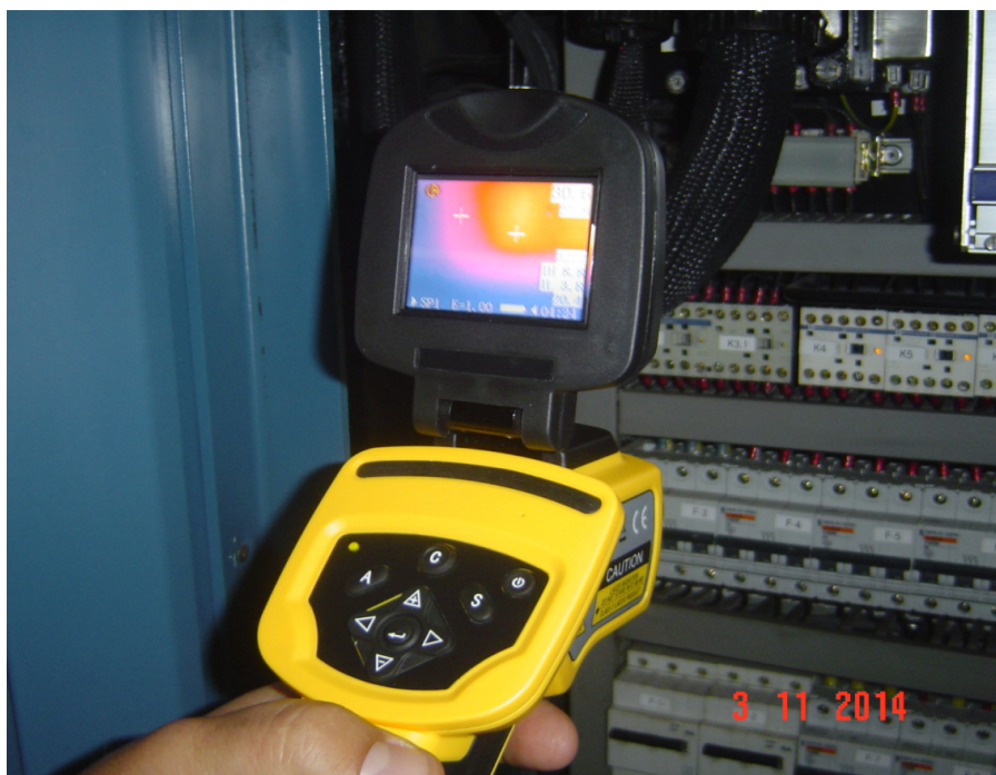
Figura 25 - Análise de contatores com a câmara termográfica. (Autor: Carlos Martinho 03/11/2014)
