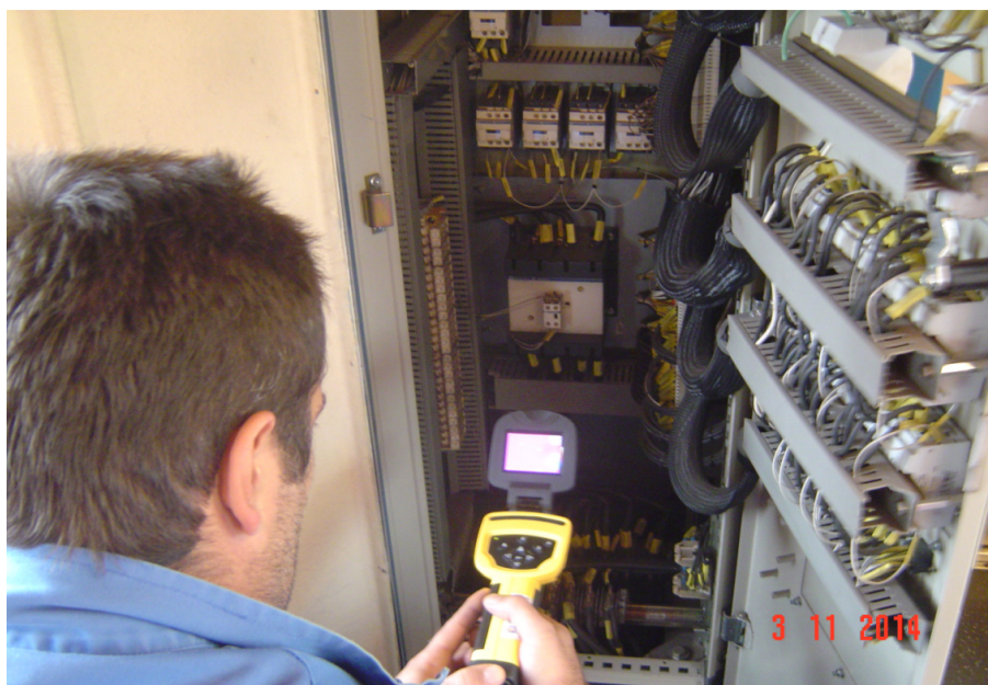
Figura 24 - Análise do armário de BT com a câmara termográfica.
