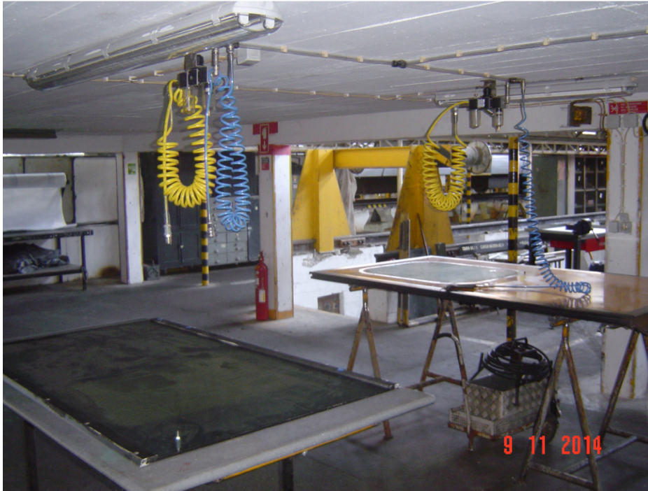
Figura 29 - Posto de reparação de vidros. (Autor: Carlos Martinho 09/11/2014)
