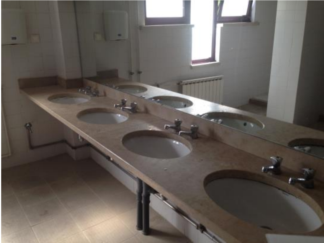
Figura 24. Torneiras dos lavatórios.
