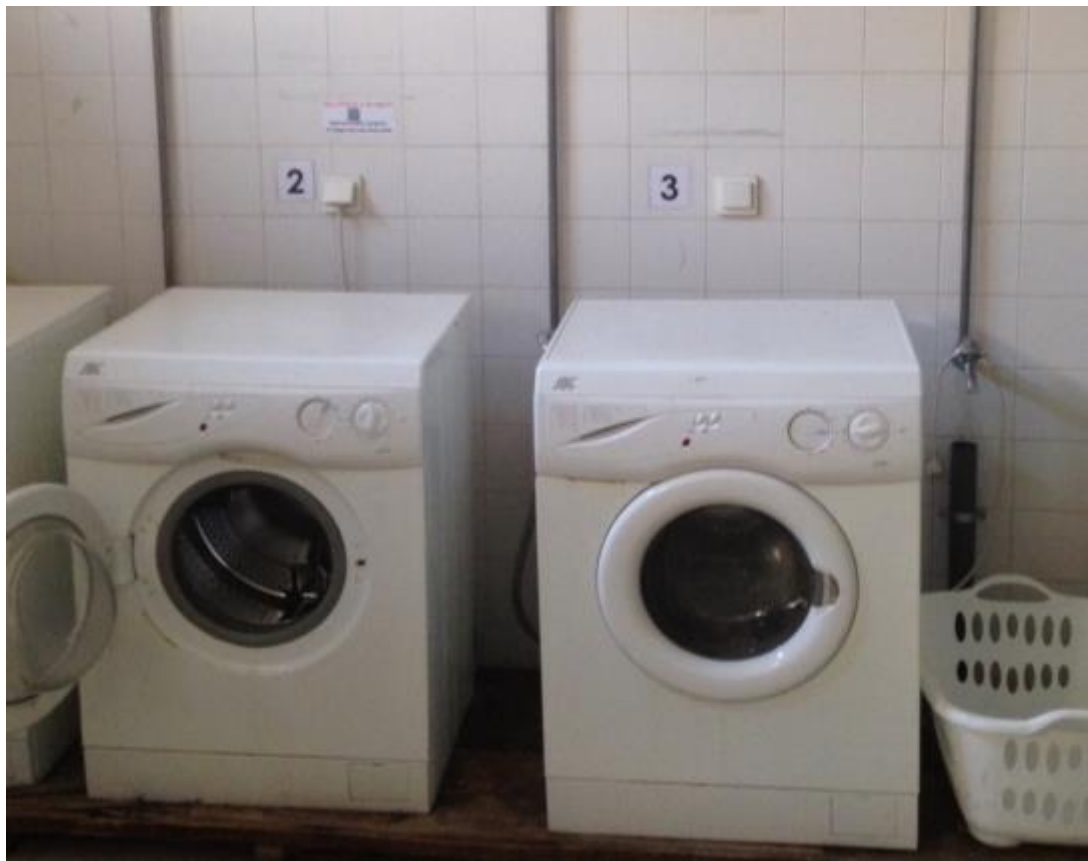
Figura 29. Máquinas de lavar existentes.
