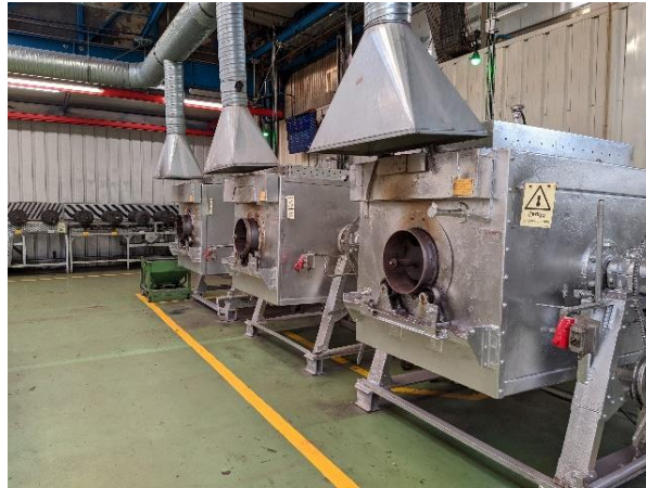
Figura 18: Alguns dos fornos utilizados no tratamento térmico.
