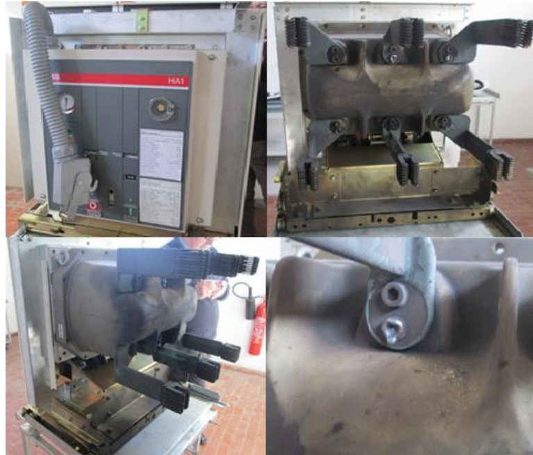
Figura 4.14 - Disjuntor ABB queimado
