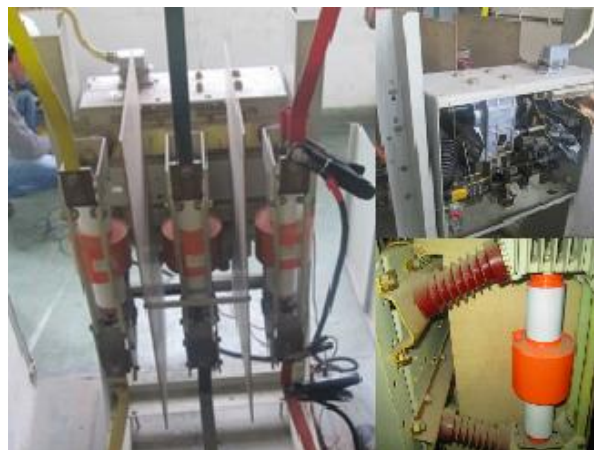
Figura 4.11 - Disjuntor SIEMENS e comando mecânico
