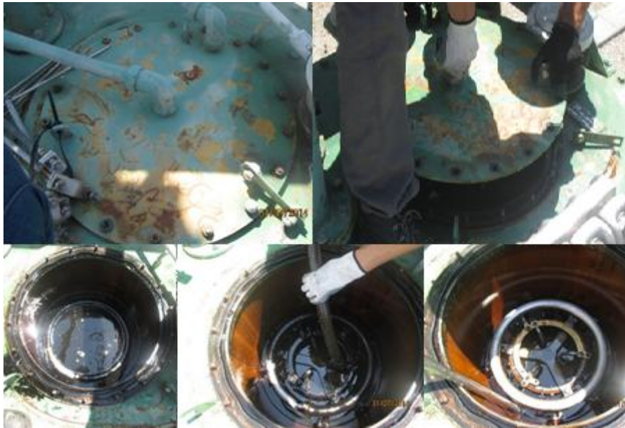
Figura 4.17 - Ruptor de transformador EFACEC
