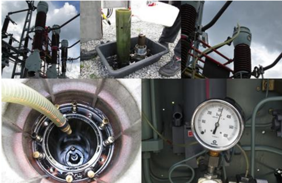
Figura 4.15 - Disjuntor EFACEC e Comando OP
