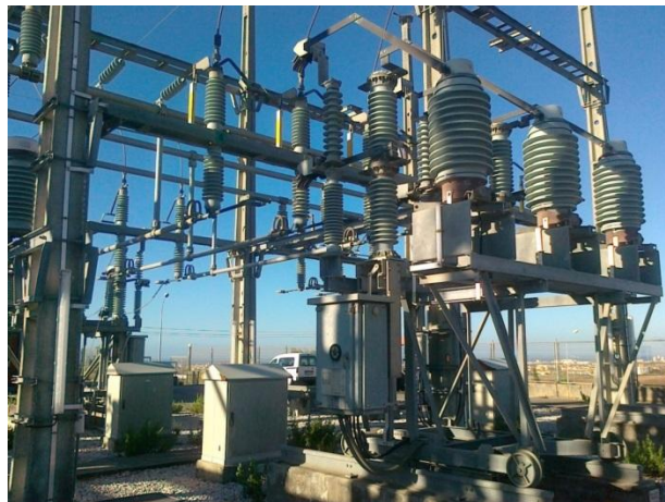
Figura 4.22 - Disjuntor revestido de SI-COAT 570 nos isoladores
