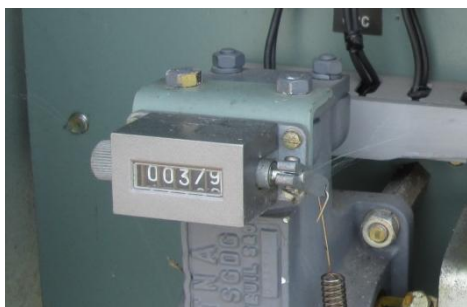
Figura 4.25 - Contador de manobras de um disjuntor a óleo com comando OP
