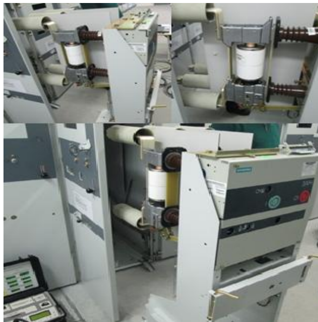
Figura 4.13 - Disjuntor SIEMENS e respetivo comando mecânico
