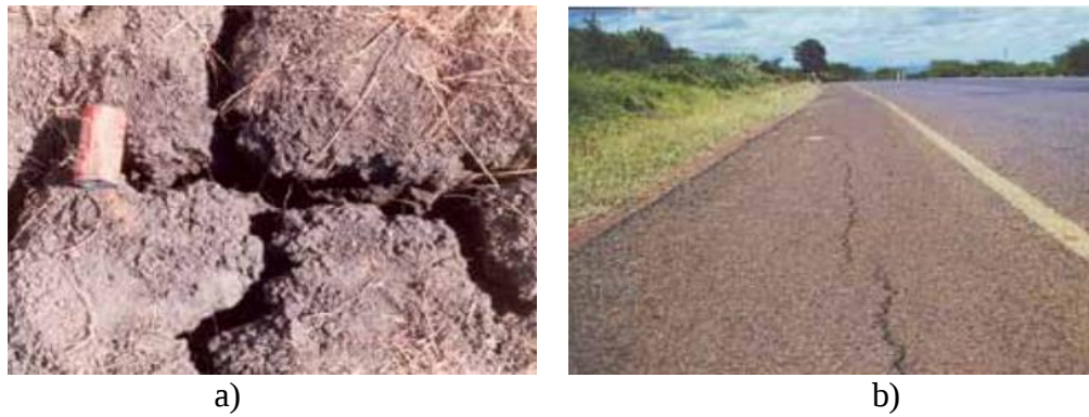
Figura 2.12 - a) Solo expansivo b) Fendilhamento longitudinal típico e deformação do pavimento causados por uma fundação de solo expansivo (ERA, 2011)
