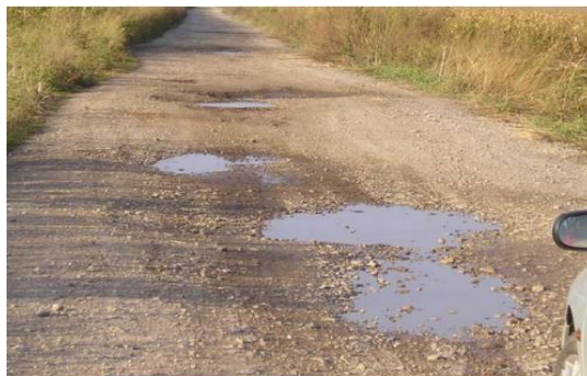
Figura 4.6 - Pavimento em cascalho com presença de covas na superfície (MAI, 2005)
