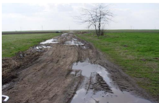
Figura 4.7 - Pavimento de solo com ocorrência de pontos fracos (MAI, 2005)
