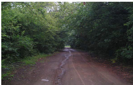
Figura 4.2 - Superfície escorregadia durante os períodos chuvosos (MAI, 2005).
