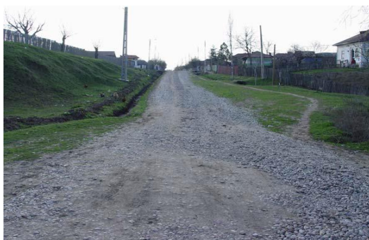
Figura 4.1 - Estrada com desagregação (MAI, 2005)
