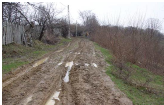
Figura 4.3 - Rodeiras em estrada de pavimento de solo (MAI, 2005).
