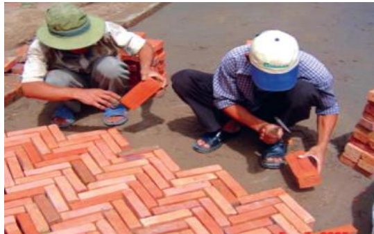
Figura 2.19 - Exemplo de pavimentação com tijolo de barro (ERA, 2011)
