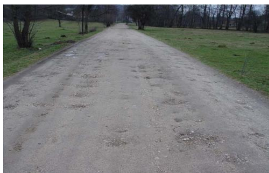
Figura 4.4 - Estrada rural com ondulação (MAI, 2005)
