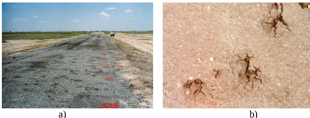
Figura 2.14 - a) Exemplo de dano grave num revestimento de pavimento devido ao ataque de sal após dois anos da construção (Botswana), (ERA, 2011); b) Danos por ataque de sal podem aparecer sob a forma de "bolhas" no revestimento principal (ERA, 2011)
