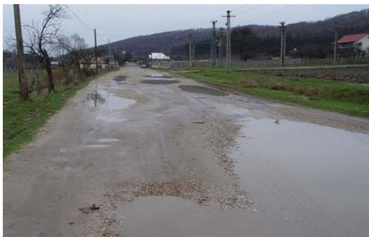
Figura 4.5 - Depressões em estrada rural (MAI, 2005)
