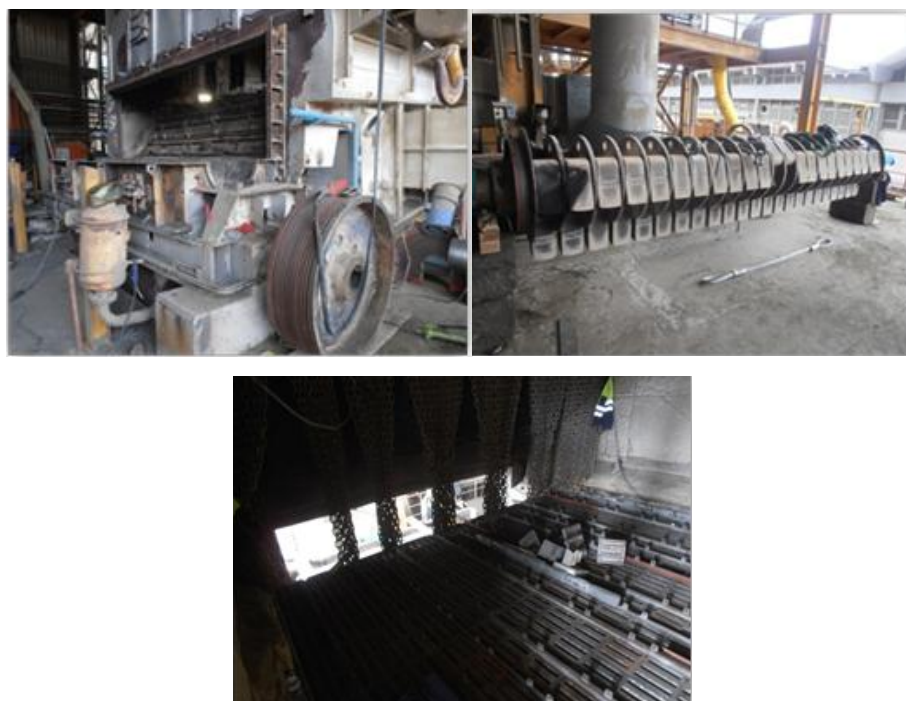
Figura 10: Britador de clínquer desmontado e o final do arrefecedor.
