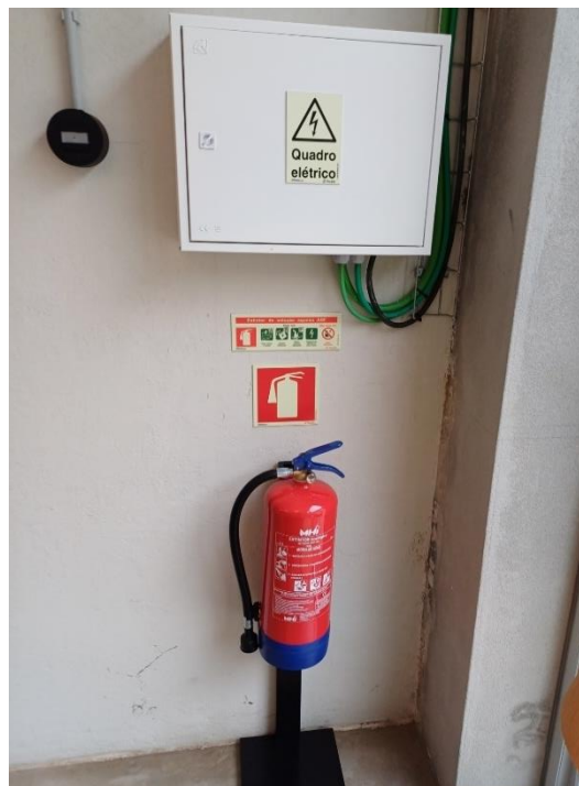
Figura 15: Placa do quadro elétrico, extintor e placas de informação no escritório.
